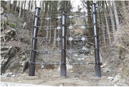
写真-1 小規模な溪流等における二次製品(透過型施設)および側方からの土砂流出防止対策(金網付)の例 7)
