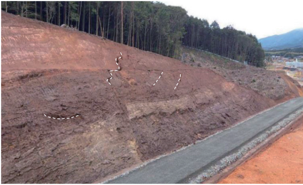
写真-1 切土法面に発生したクラック（白の破線）の状況
