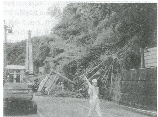
写真-2 岩国市池ヶ迫における表層崩壊
