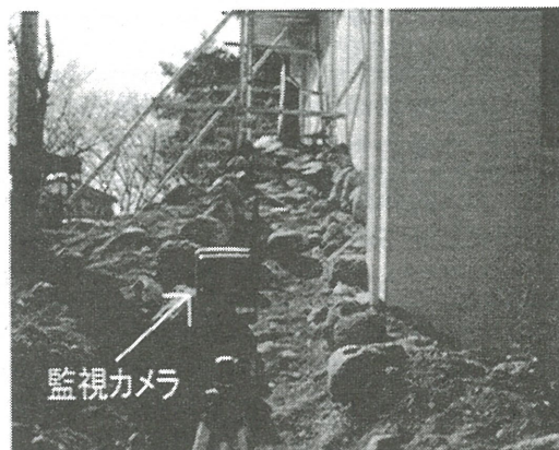
写真-1 監視カメラの設置状況
