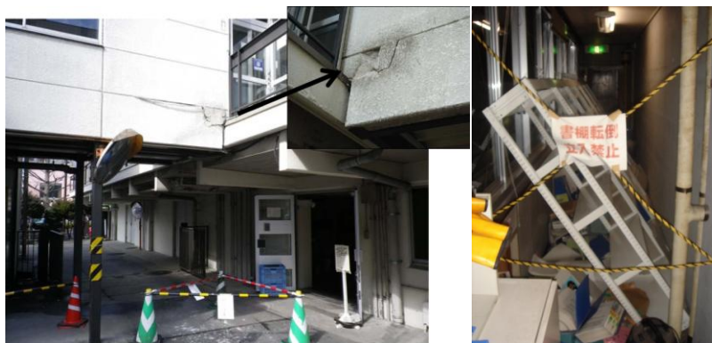
図 3：庁舎の被災状況
