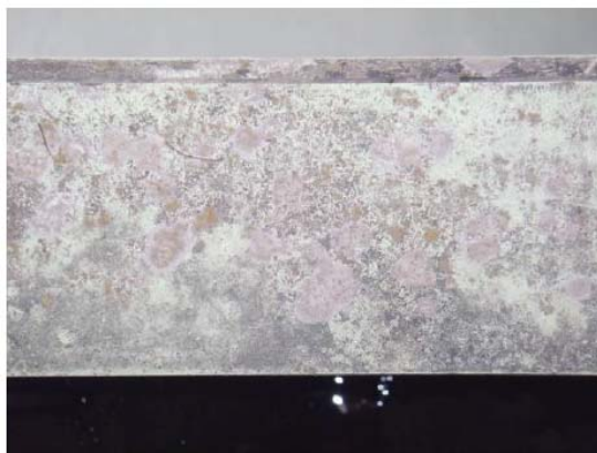
図 4.3.12 FRP 部材の紫外線による表面性状劣化 4-23)
