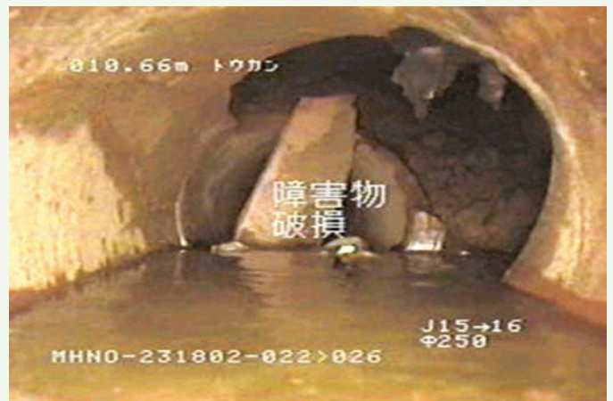
老朽化等による下水管の破損（国土交通省資料）
