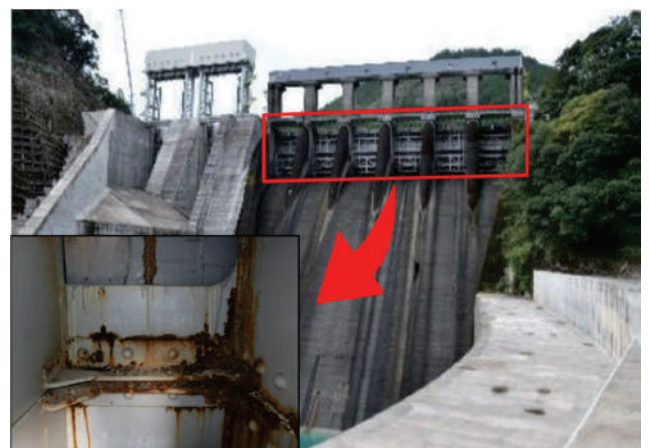
常用洪水吐（クレストゲート）の老朽化による鋼材の腐食状況の事例。このままでは腐食が進行し、構造物の機能に支障が生じる可能性があるため、早期に措置をすることが望まれます。
