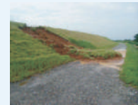
雨水の堤防への浸透に起因して法崩れが発生した様子。堤防機能に支障が生じており、直ちに措置を要します。
