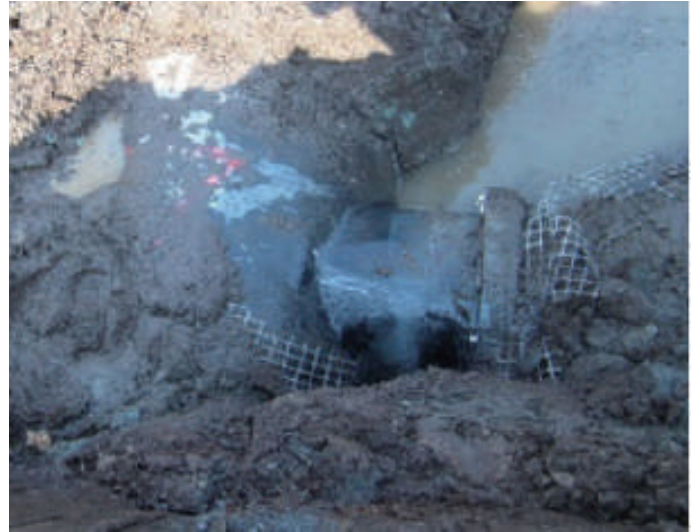
写真 管水路の漏水破損事例
