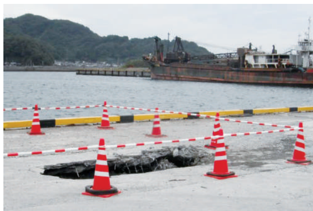
岸壁の陥没（エプロン部）
