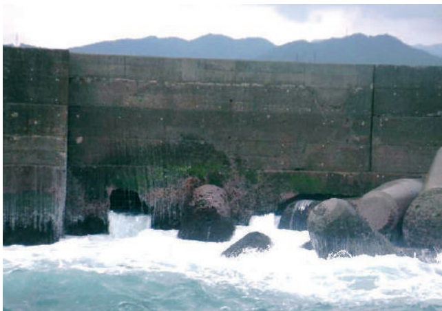
防波堤の損傷（ケーソン側壁の穴あき）
