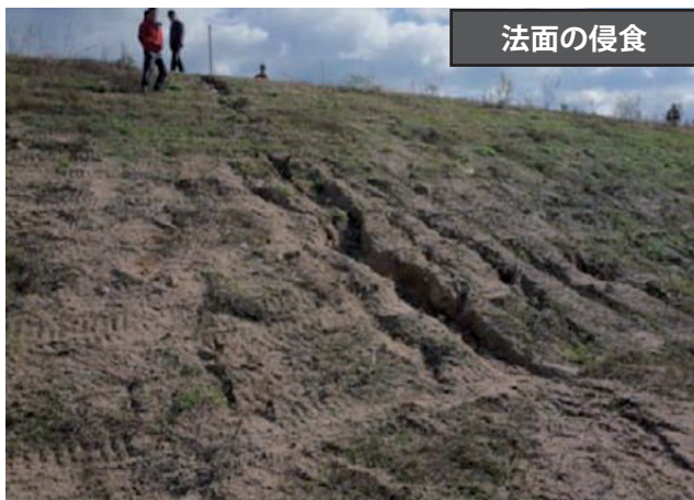
天端や小段の構造や不陸による雨水の集中、法面の植生の状況によって、侵食（ガリ）が生じる場合があります。特に雨水の集中は、侵食の助長によりさらなる変状拡大の可能性があるため適切な措置を要します。
