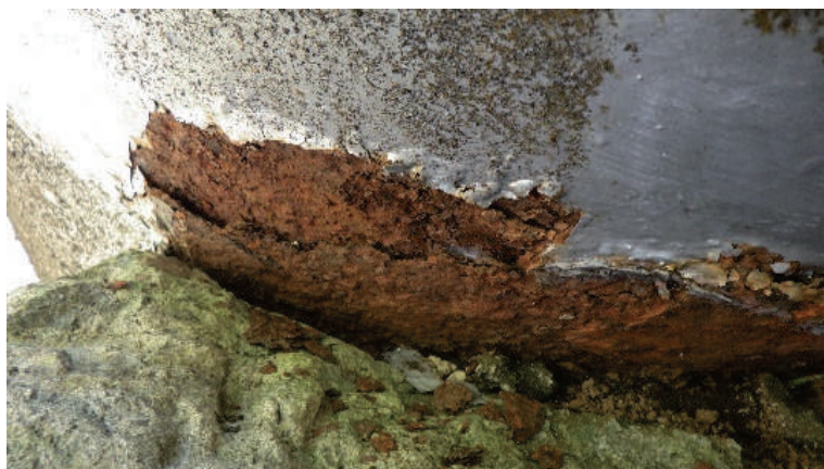
水圧鉄管 塗装劣化状況
