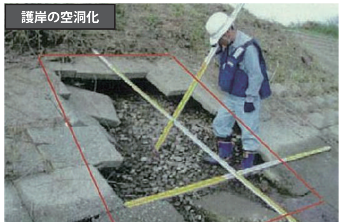
護岸が部分的に流出し、護岸背面の土砂が吸い出され、空洞化が進んでいる様子です。護岸の機能が失われており、適切な措置を要します。
