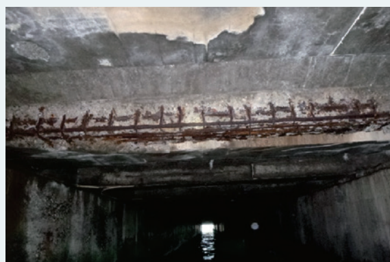
栈橋の老朽化（上部工コンクリート）
