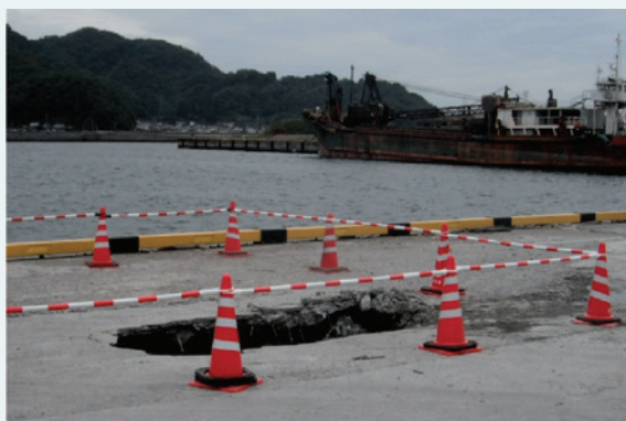
岸壁の陥没（エプロン部）
