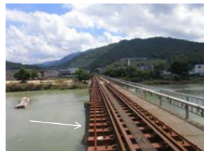
JR芸備線、中央部が洪水により歪んでいる。
