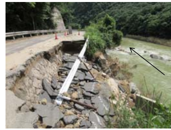
沼田川歩道落橋部の下流の浸食被害
