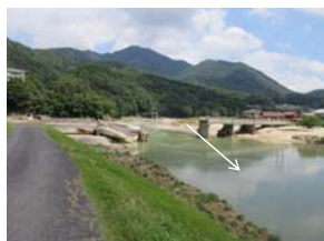
落橋した道路橋の様子
