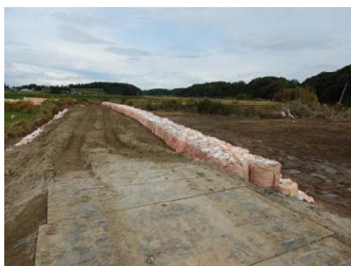
写真 4.3.10 鈴川堤防決壊(川裏洗堀)
