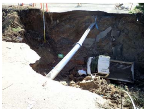
写真 4.2.3 五十沢地区の道路陥没 (撮影点: N37.796270, E140.923415)
