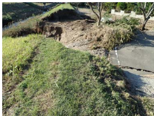
写真 4.2.8 佐久間川右岸の破堤 (撮影点: N37.857888, E140.553830)
