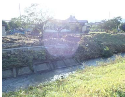
写真 4.2.7 佐久間川左岸の破堤 (撮影点: N37.857888, E140.553830)
