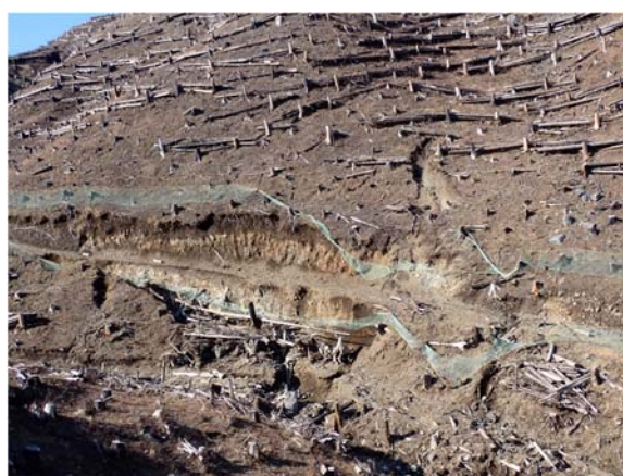
図 2.4.12 崩落した作業道
