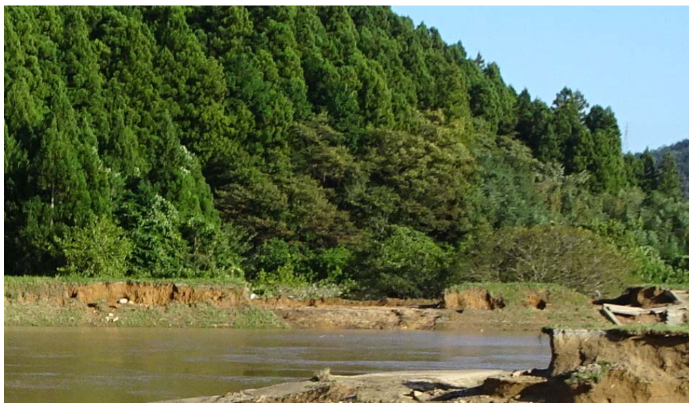
图3.4.13 堤防決壊箇所 (内川, Pt. 7, 2019年10月13日)
