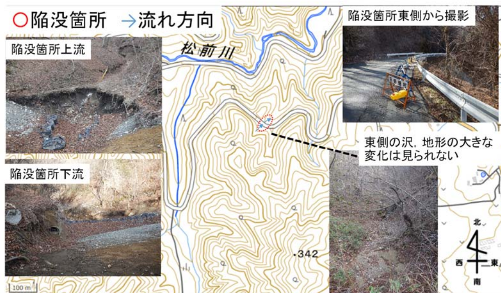
図 2.2.14 田野畑村の道路陥没箇所（国土地理院地図に写真とコメントを追加）
