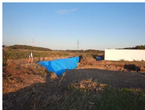
写真 4.4.18 金谷地区の決壊箇所
