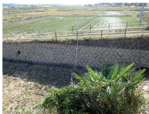
写真 4.2.2 損傷した山付堤背後の湛水痕 (撮影点: N37.885187, E140.625892)
