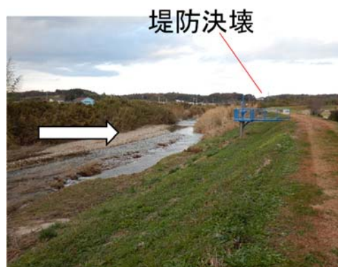
写真 4.4.16 堤防決壊付近の河損状況
