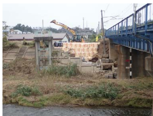
写真 4.2.14 第二中川橋梁直上の破堤 (撮影点: N37.517562, E140.399178)
