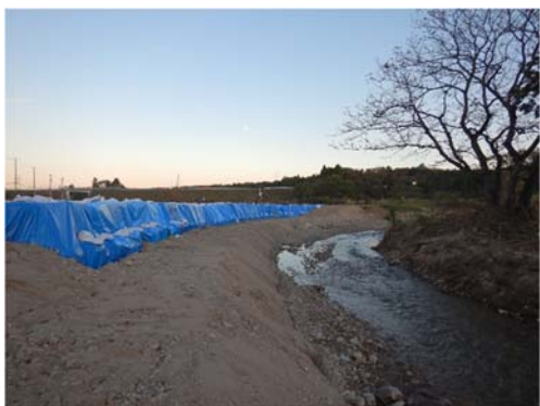
写真 4.4.19 川房川の決壊箇所
