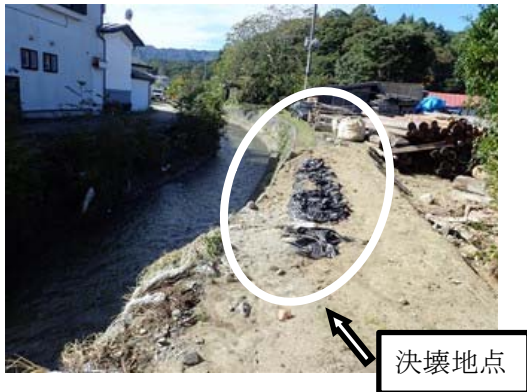
写真 2.3.4 護岸の決壊箇所
