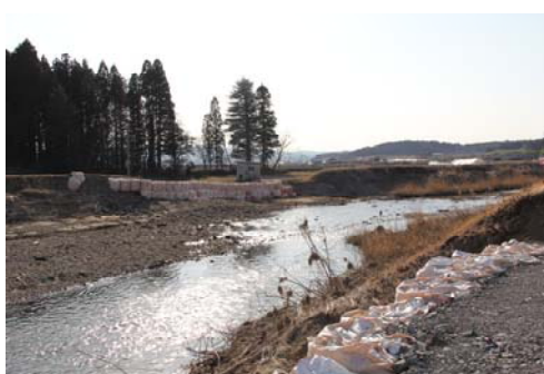
写真 4.3.15 護岸巻き上げた堤防決壊
