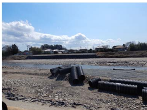
写真 4.4.23 小川町の堤防破損
