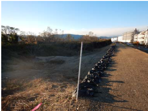
写真 4.4.35 堤防決壊全景
