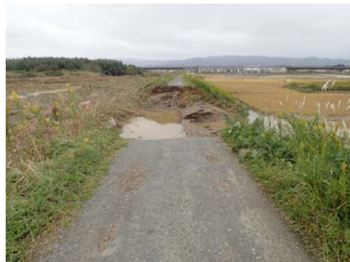
写真 4.4.6 破堤部② (撮影点: N40.000000, E140.000000)
