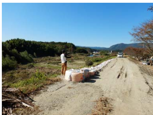
写真 4.4.33 堤防決壊全景
