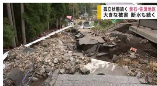
写真 2.3.9 佐須地区の被害状況 17)
