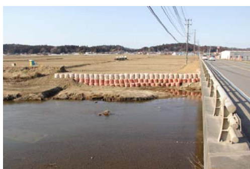
写真 4.3.16 橋梁側近の決壊
