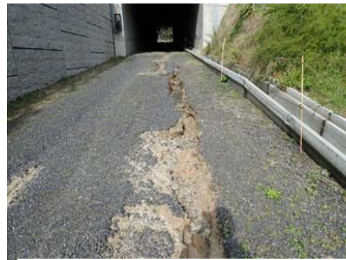
写真 2.3.5 道路の洗掘の様子
