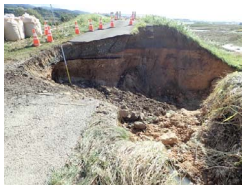
写真 4.2.1 梁川町五十沢の堤防損傷 (撮影点: N37.885135, E140.625857)
