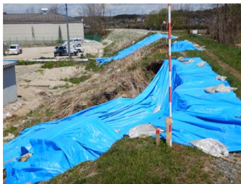
写真 4.3.3 上流側堤防決壊状況
