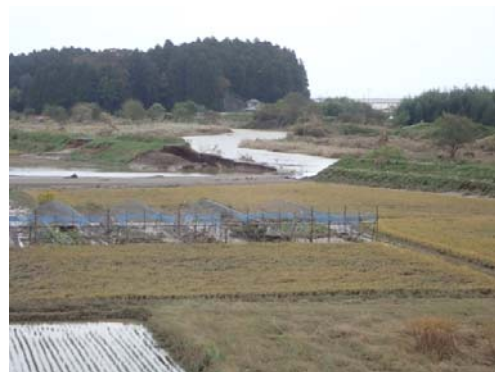
写真 4.4.5 破堤部① (撮影点: N40.000000, E140.000000)
