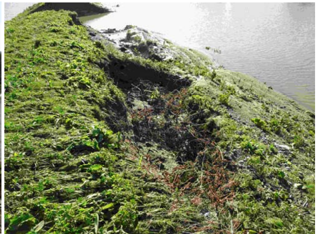
图3.4.11 堤防決壊箇所 (新川, Pt. 4, 2019年10月13日)
