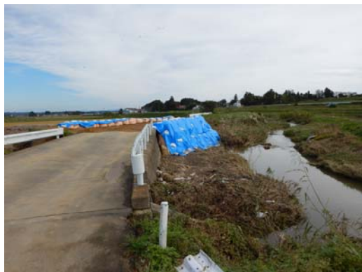
写真 3.2.2 熊谷川破堤地点
