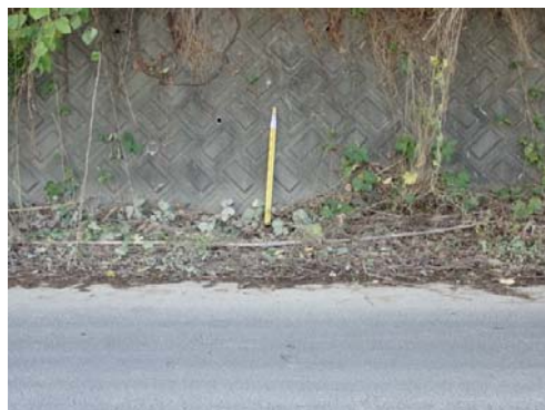
写真 4.2.6 県北浄化センター付近の痕跡 (撮影点: N37.866000, E140.568303)
