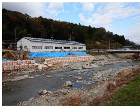
写真 4.4.15 堤防決壊付近の護岸損壊と浸水被害
