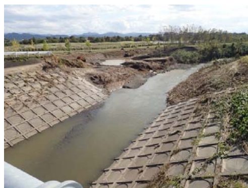
写真 4.2.5 国見町の欠下橋の被害 (撮影点: N37.806123, E140.943556)
