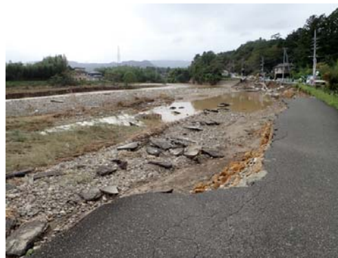
写真 4.4.1 宇多川左岸の河岸浸食 (撮影点: N40.000000, E140.000000)
