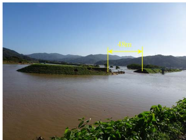
図3.4.8 堤防決壊箇所（新川，Pt. 1，2019年10月13日）
