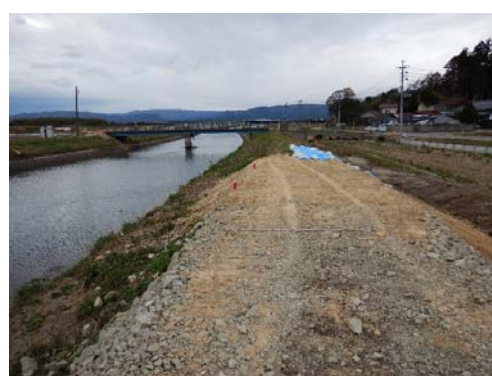
写真 4.4.8 小泉川の決壊箇所
