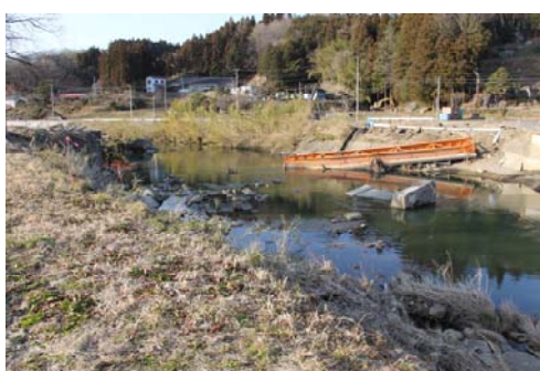
写真 4.3.17 浅川町・石川町境界付近の落橋
