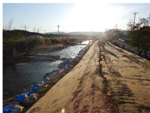
写真 4.4.17 小屋木地区の決壊箇所
