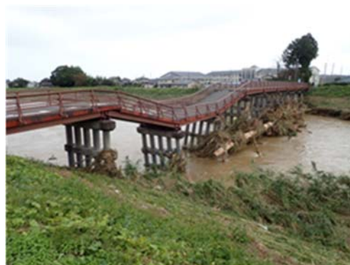
写真 4.4.2 中橋の沈下 (撮影点: N40.000000, E140.000000)
