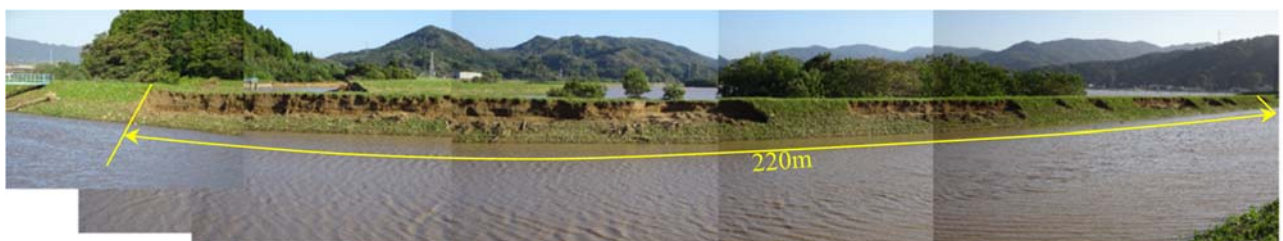
図3.4.9 堤内地からの流れによる法面洗掘箇所（新川，Pt. 2，2019年10月13日）
