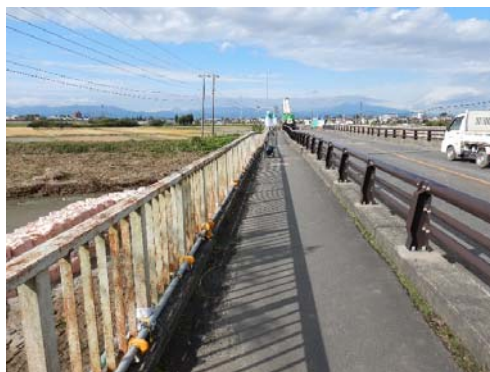
写真 4.3.6 谷田川大善寺橋損傷状況
