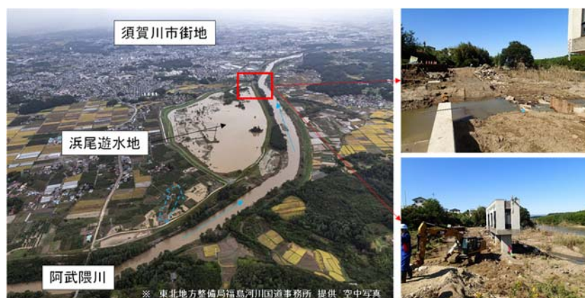
写真 4.3.7 浜尾遊水地 浜尾第 2 樋門付近の堤防決壊
