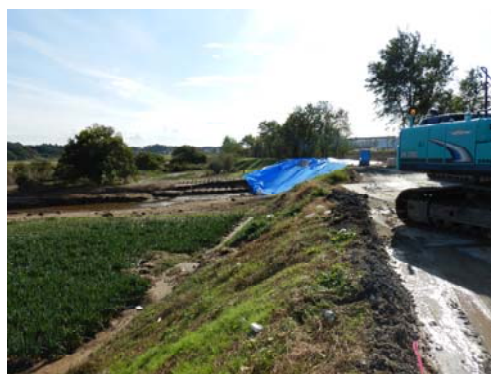
写真 4.3.4 下流側決壊と漏水状況
