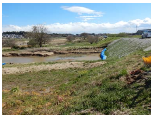
写真 4.3.5 6ヶ月後の漏水
