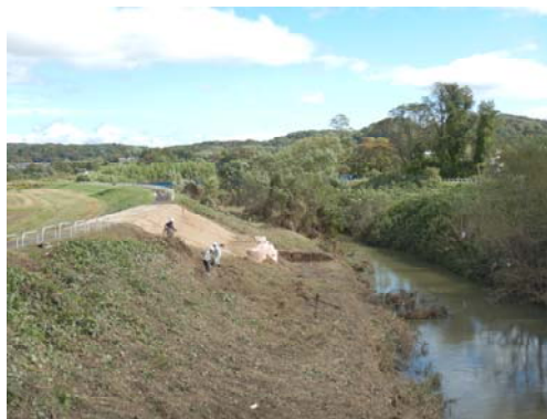
写真 4.3.1 下流側堤防決壊
