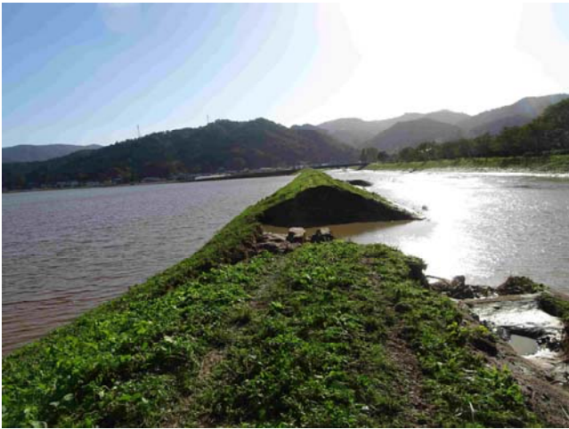
图3.4.10 堤防決壊箇所 (新川, Pt. 3, 2019年10月13日)
