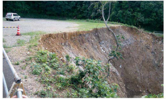
阿南市椿泊の道路崩壊。県道の盛土が崩壊し、YMCAで研修中の子どもたちが孤立。海上保安庁の巡視船で救出された。
