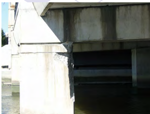
端部柱の柱梁接合部付近の損傷
