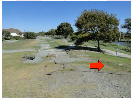
橋台周辺の地盤変状
