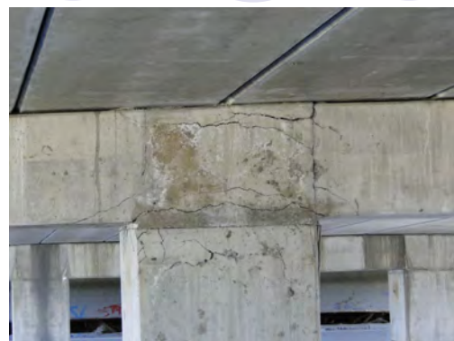
中央部の柱の柱梁接合部の損傷
