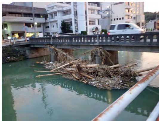
写真08(はまだ橋にかかる流木)
