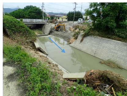
橋梁下流の右岸被災状況
