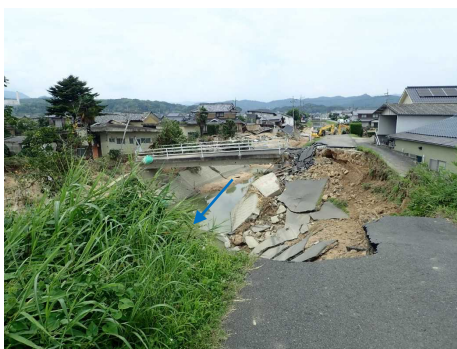
橋梁下流の左岸被災状況
