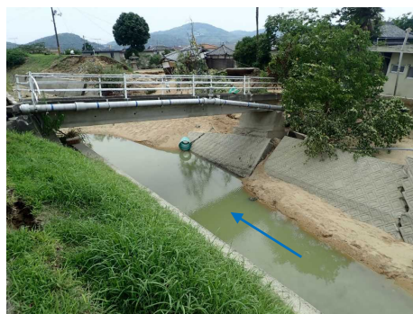
橋梁下流の右岸被災状況
