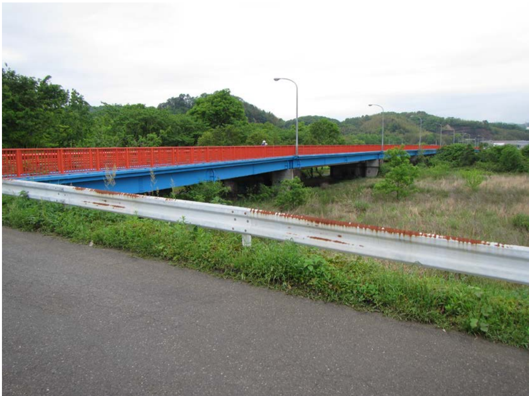
乙女橋を上流側から撮影。街灯付近で、不連続的に変化している様子が分かる。
