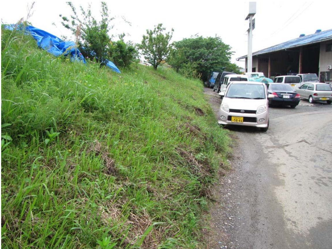
堤防が裏のり面側に変形し，裏のり尻では急勾配化している模様.
