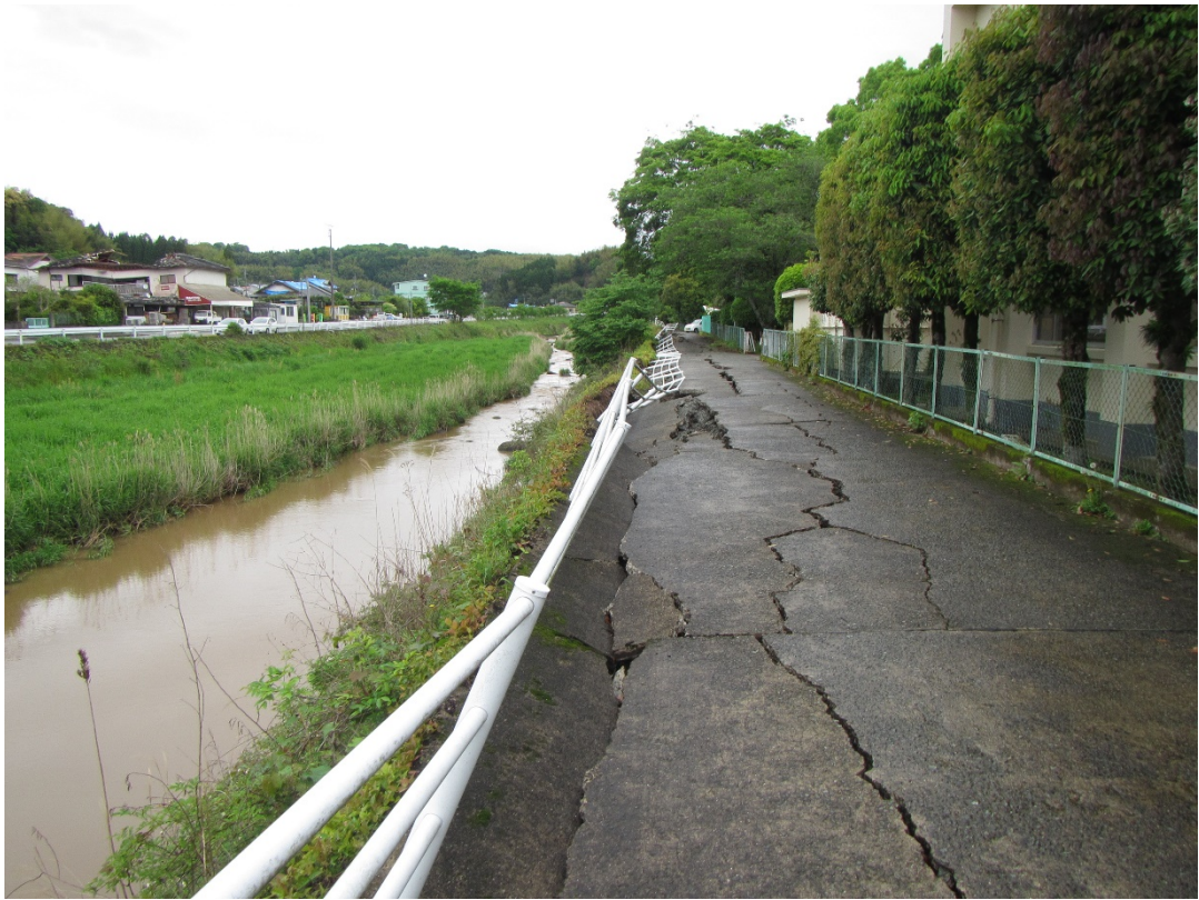
崩壊現場の上流より撮影．天端の縦断亀裂が発生（100m 以上の区間）．横断亀裂も見られる．
