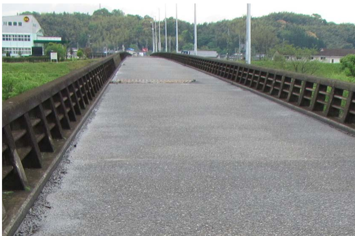
橋梁内のつなぎ目も縦ずれが生じていた.
