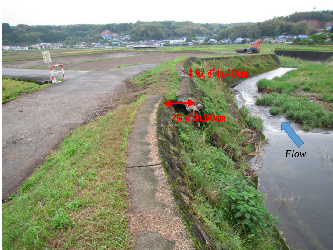
左岸側堤防の変形．堤防が川側に 90 cm移動し，縦方向には 40 cmずれていた．
