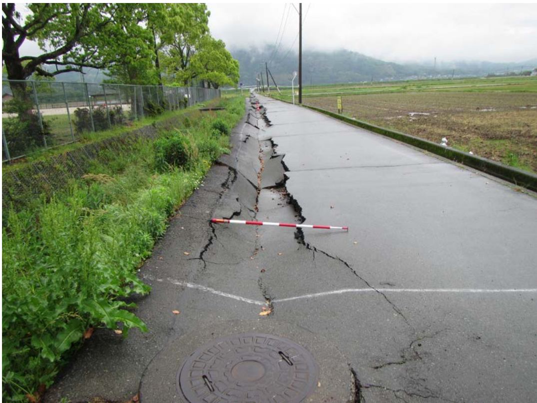
道路の陥没（長さ 200m 以上）．マンホールを繋ぐ管路部分が陥没．幅 120 cm，40 cm程度陥没．
