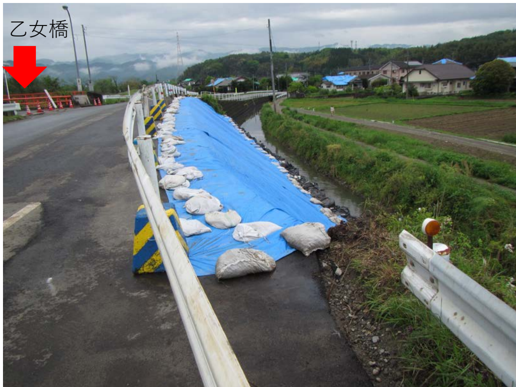
乙女橋の左岸堤防の裏のり面が法すべり. L=50\text{m} . 裏のり面勾配はだいたい 5 分.
