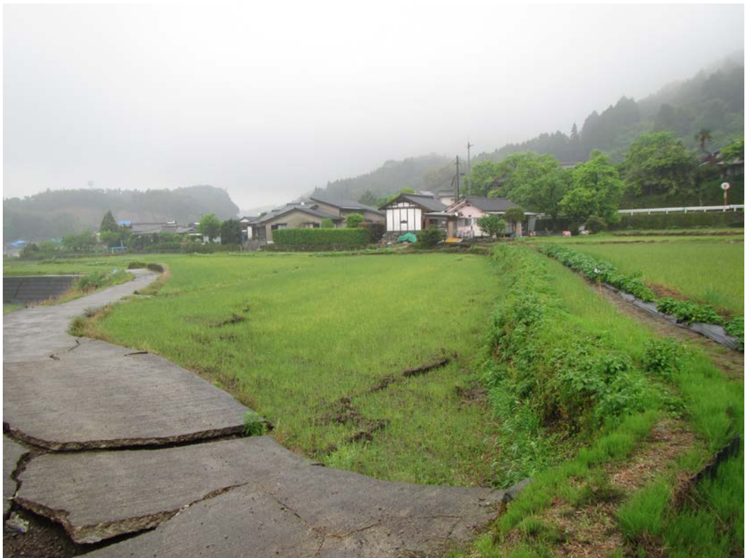
右岸側の畑にも断層が出現。2本出現。断層上と思われる家屋には大きな被害は見られなかった(左岸も同様)。
