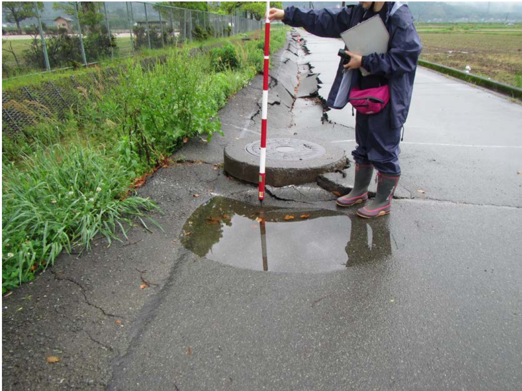
秋津川左岸側の道路（グランド脇，木山川に繋がる道路）．マンホールの浮き上がり（10 cm程度）．液状化した模様．
