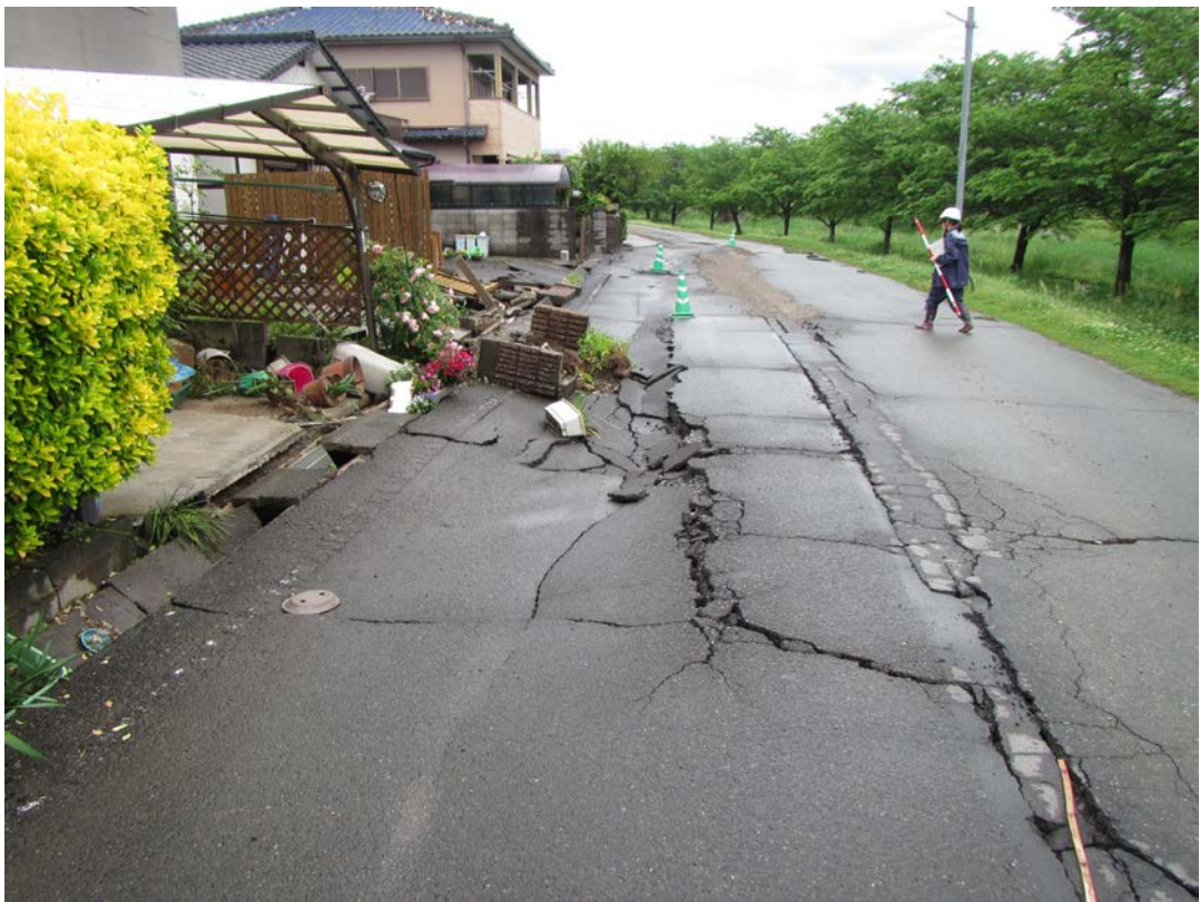
秋津川右岸側の堤防道路でも陥没（長さ 23m）. 他にも縦断亀裂.
