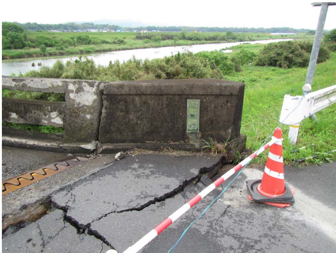
田口橋左岸側. 橋梁と堤防の接続部で段差 (10 cm程度).
