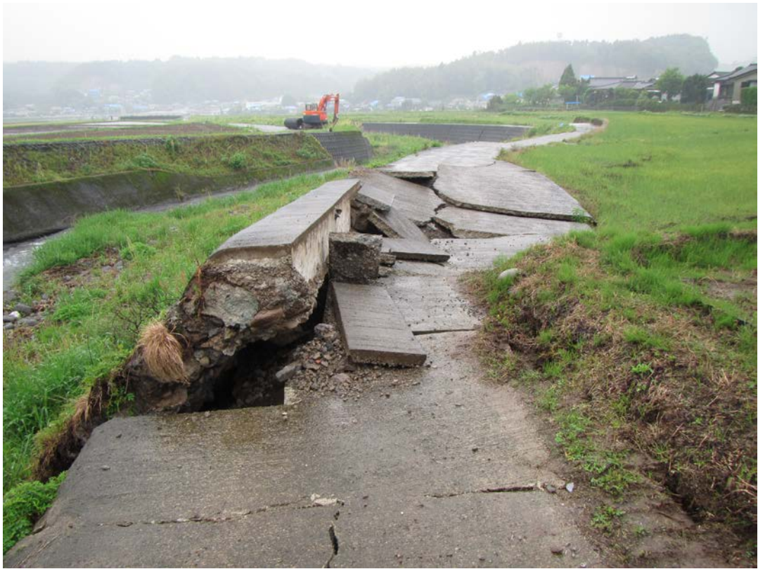
右岸側堤防も大きな被害。全体的に浮き上がり，高低差は最大 90 cm. コンクリート舗装された天端も広い範囲で割れていた。
