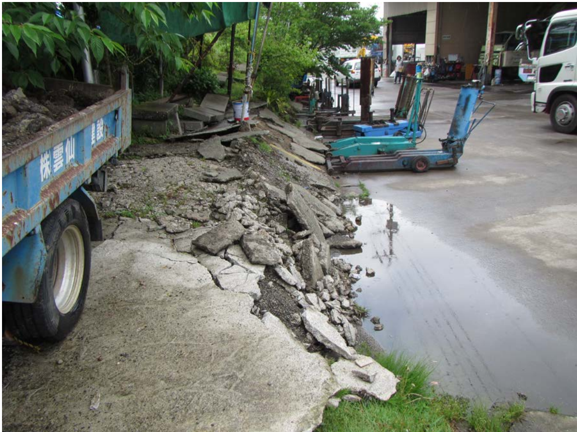
裏のり尻部のコンクリートが割れていた.
