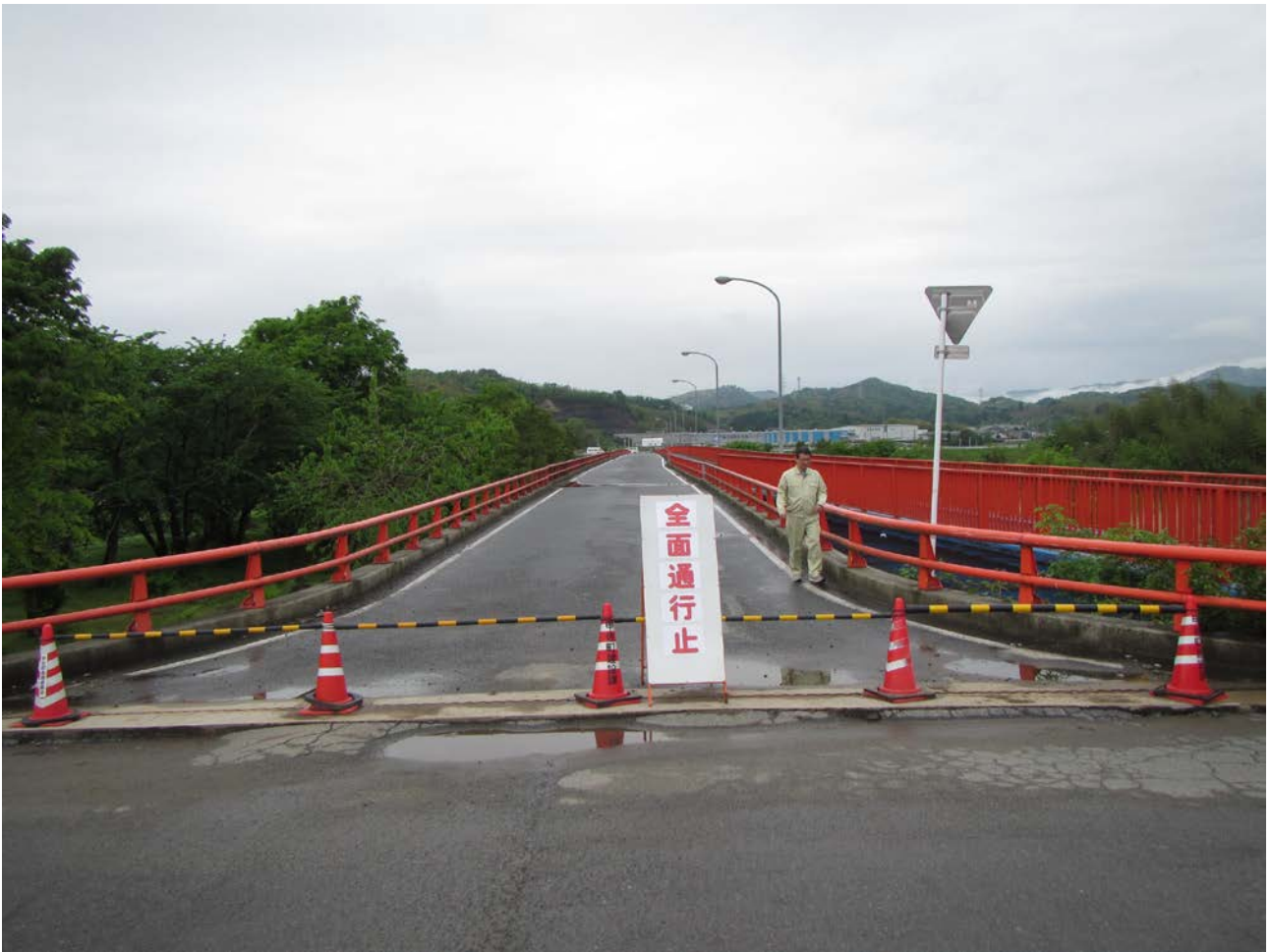
乙女橋を左岸側から撮影。橋が鉛直方向だけでなく、水平方向にも変位している様子が分かる。
