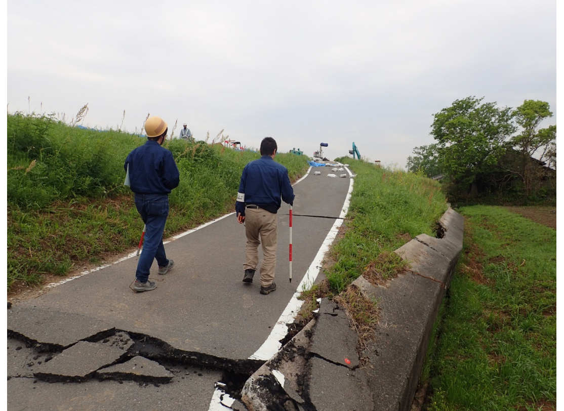
川裏側: 擁壁, 接続道路の破損
