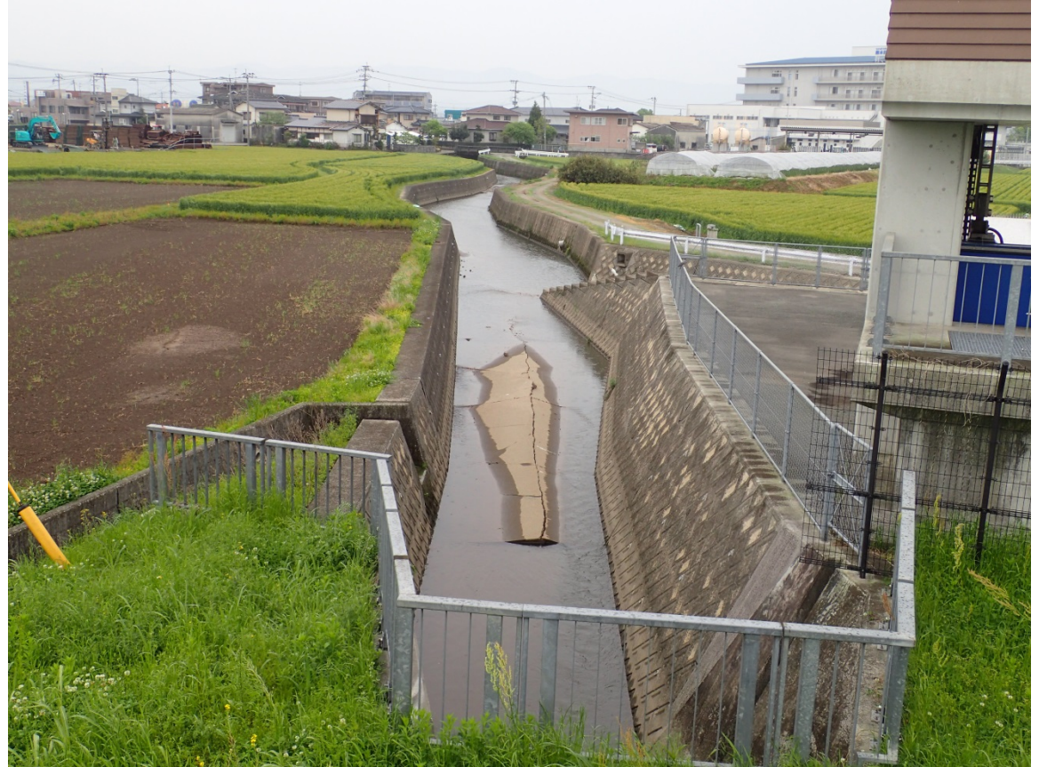
排水路内：隆起跡
