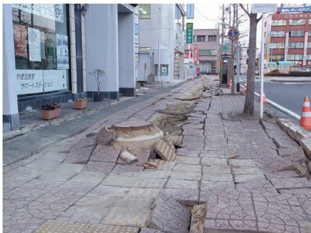
写真 8-1 古川駅前の陥没した歩道の様子。マンホールが 50 cm 程度浮き上がる (図 8-1: 125)
