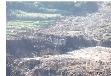
阿蘇大橋の右岸側の橋台が残ってい る。国道57号は路体部分も完全に流出
