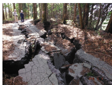
尾根部の地獄・池の窪線の亀裂
