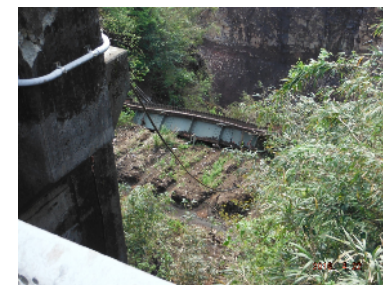
左岸側斜面に残っ ている橋桁の一部
