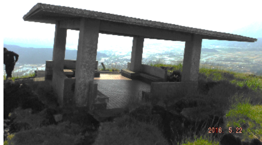
ミルクロード兜岩展望所の 亀裂の状況 休憩所が傾いている 深い亀裂は深さ:3m、幅1m
