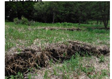
崩壊斜面上端部の平坦地に見られる亀裂
