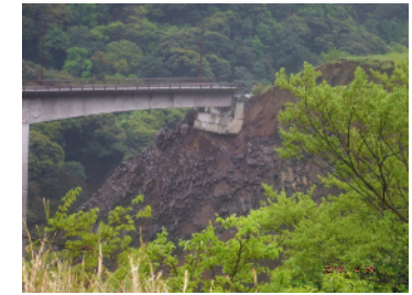
右岸側橋台の基礎岩盤の崩落
