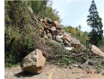
国道445号を埋めた崩壊土石
