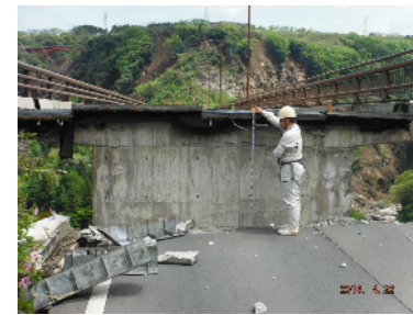
大橋と取り付け道路は縦方向170cm、横方向に150cmずれ
