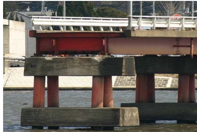
鉾田市側の落橋部分
