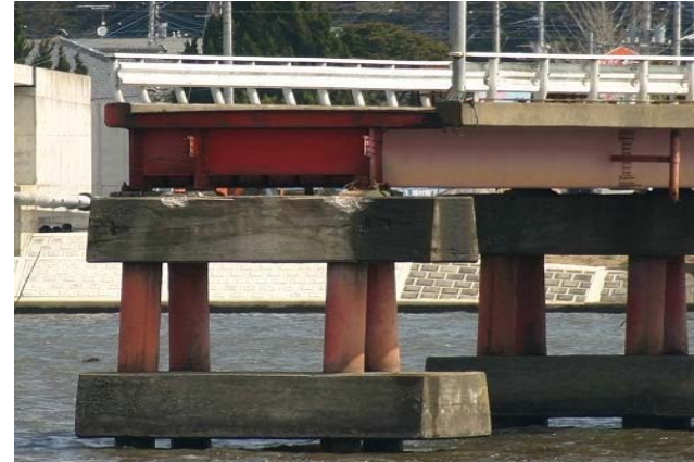
鉾田市側の落橋部分
