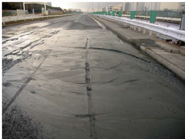
路面変状(液状化)
