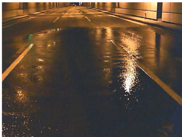
トンネル継目からの漏水
