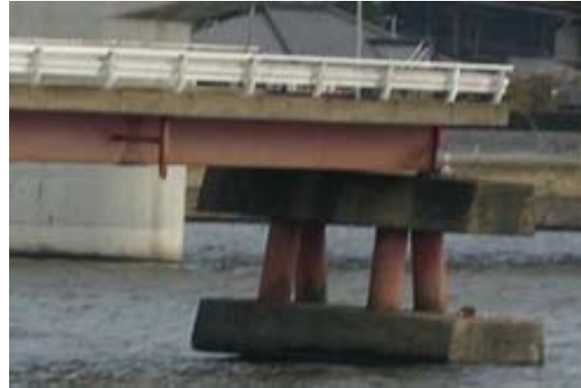
行方市側の落橋部分
