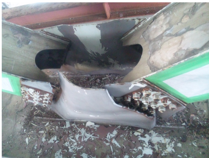
取付部材(横支材一対傾構)の損傷
