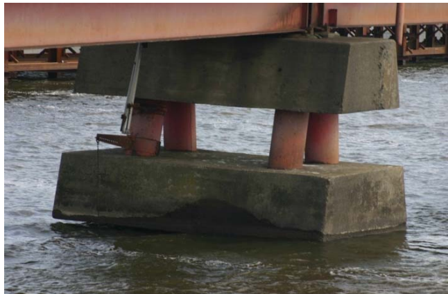
崩落していない部分
