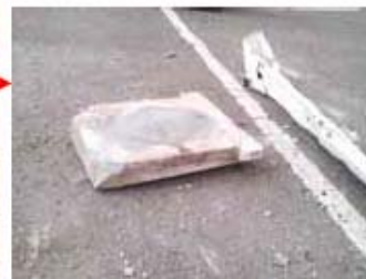
脱落した支承の一部
