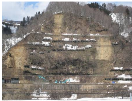
②JR飯山線越後田中駅付近 河岸段丘斜面崩落により，雪崩予防柵や線路などが 破壊されている。鉄道については既に復旧工事が進め られている。
