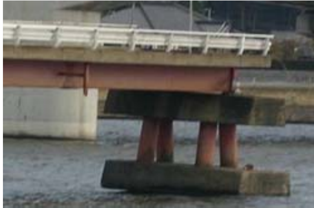
行方市側の落橋部分
