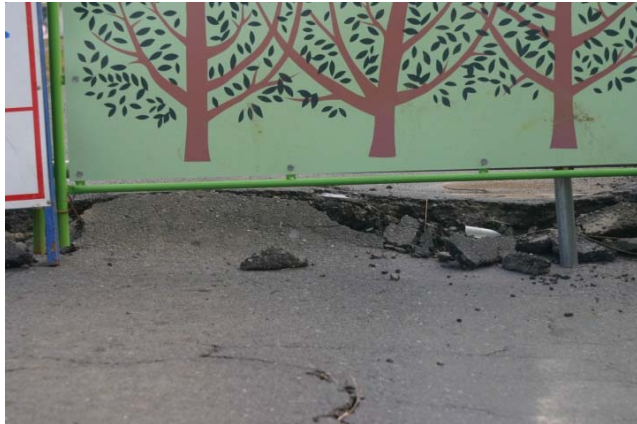
接続部の様子
