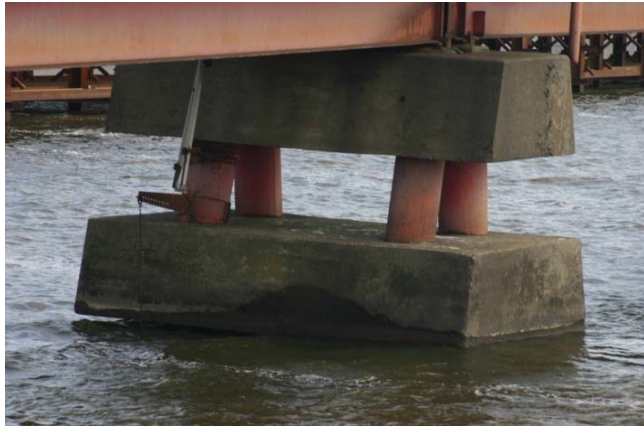
崩落していない部分
