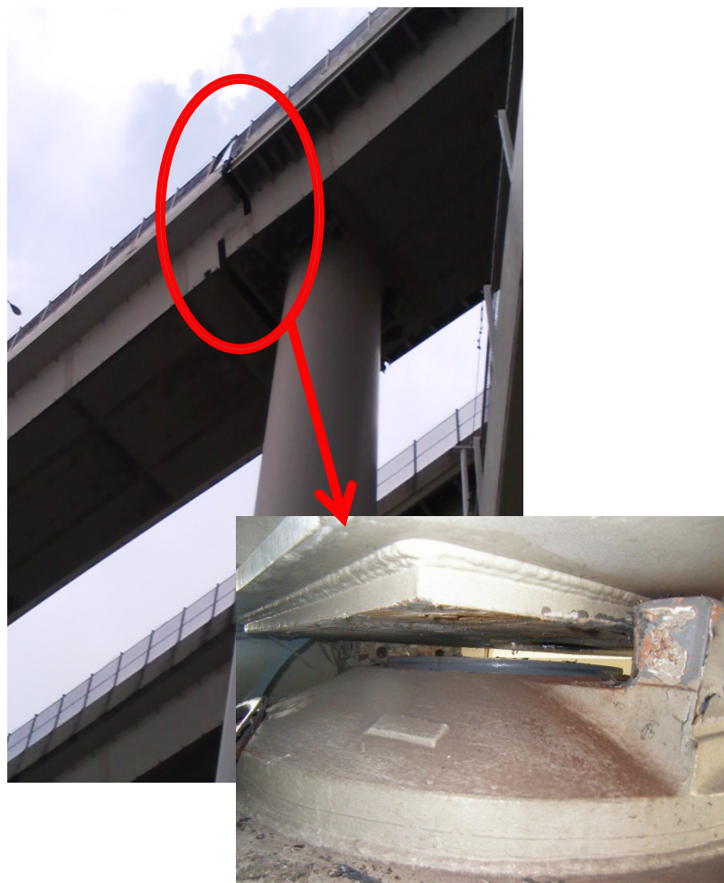
桁橋を支持する支承が脱落
