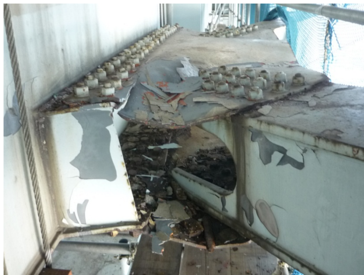
取付部材(横支材一下横構)の損傷
