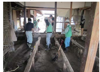
写真 4.4 住宅の泥のかき出し
