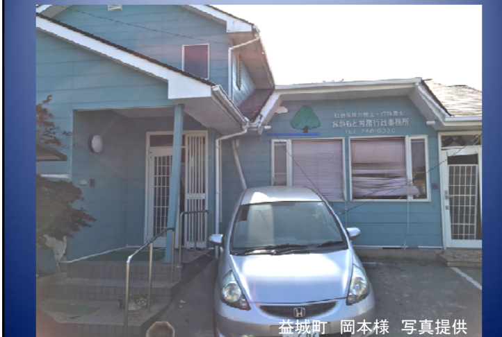
前震後 新耐震 築20年
