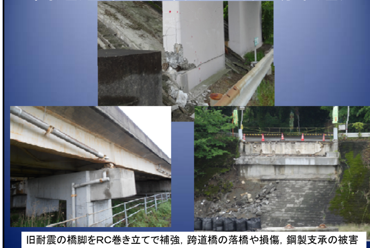
高速道路の被害(九州自動車道)
