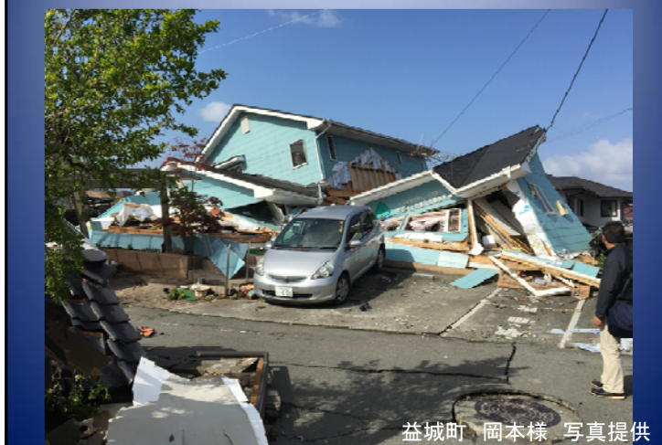
本震後 新耐震 築20年
