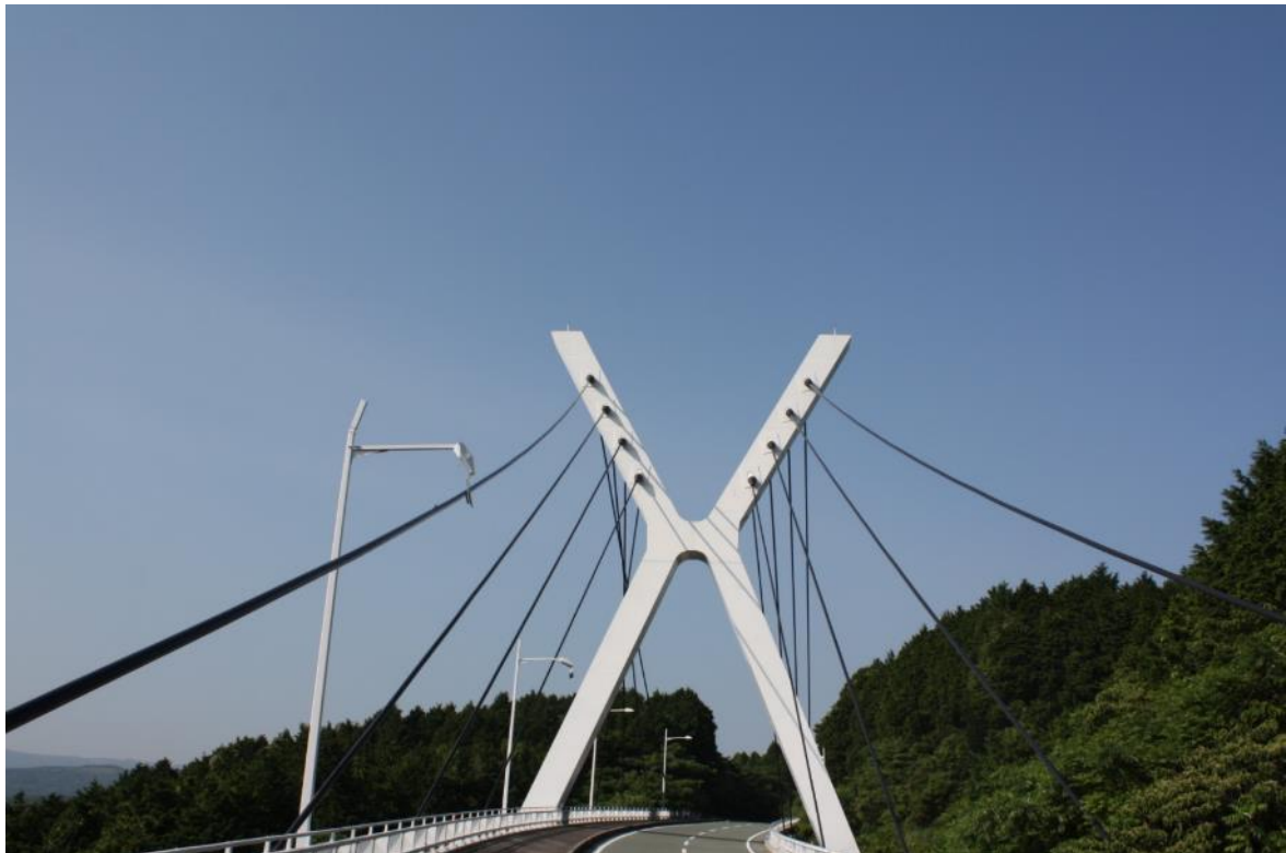
ケーブルが撓んでいる。
