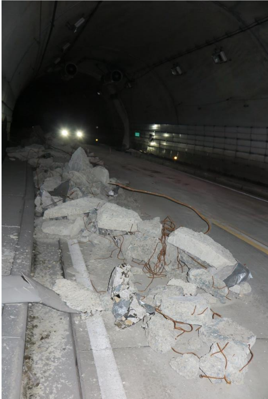
盤膨れ部の側壁部から落下したコンクリート破片、鉄筋があり
