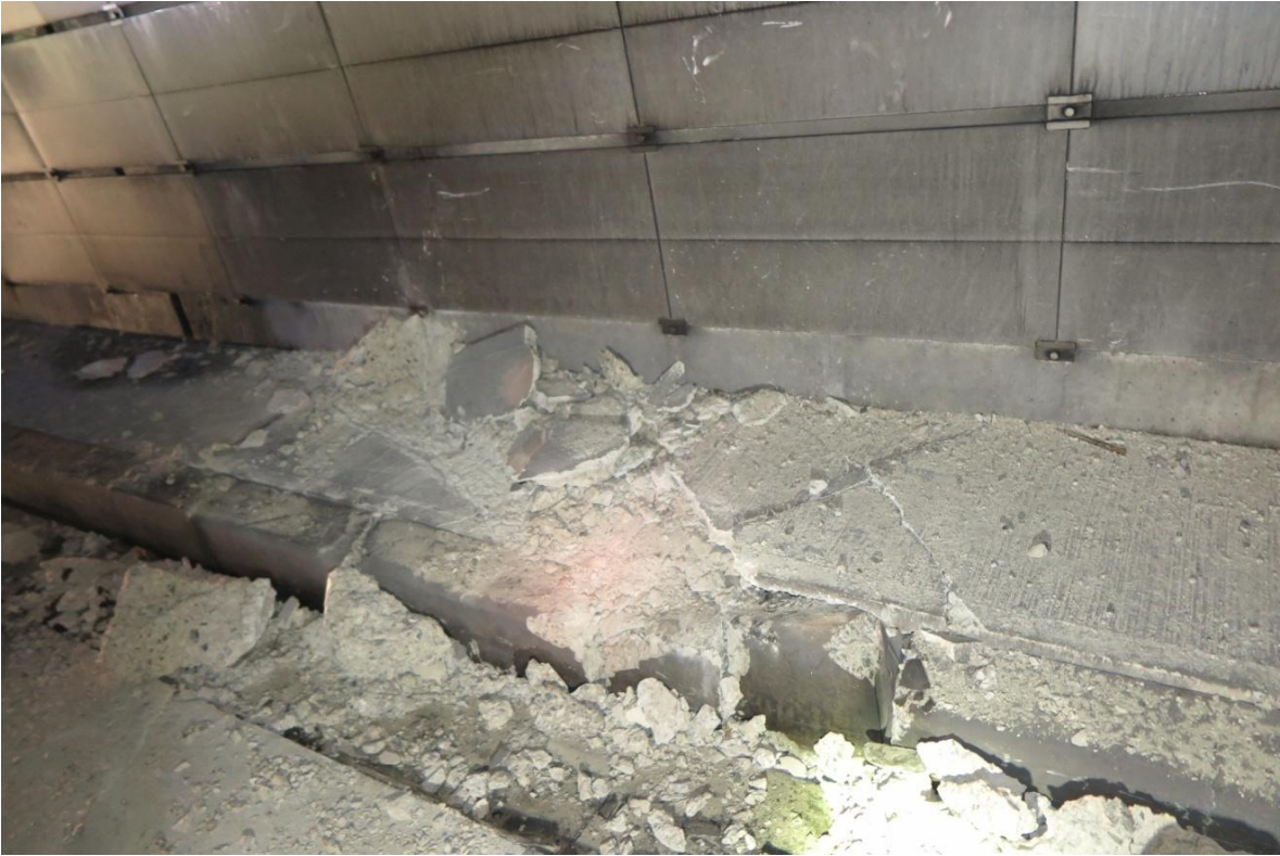
両サイトの舗装版が圧縮によって浮上がり
