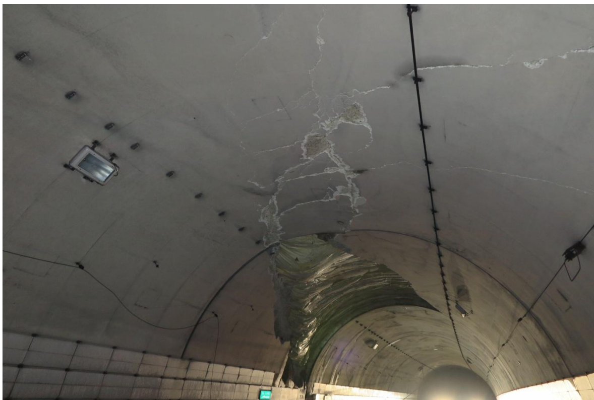
覆工コンクリートが崩落した空間の先端において交差したクラックが右側に伸びた。
