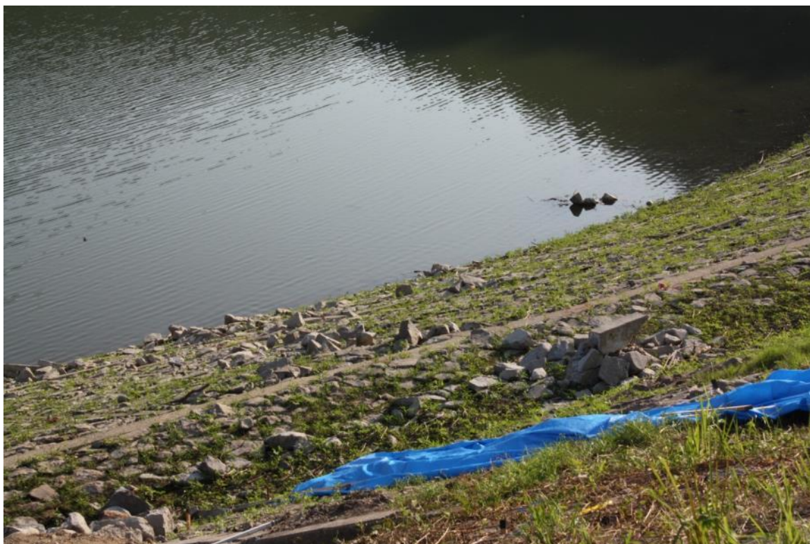
大切畑ダムの堤体（一部の積み石が食い出している）
