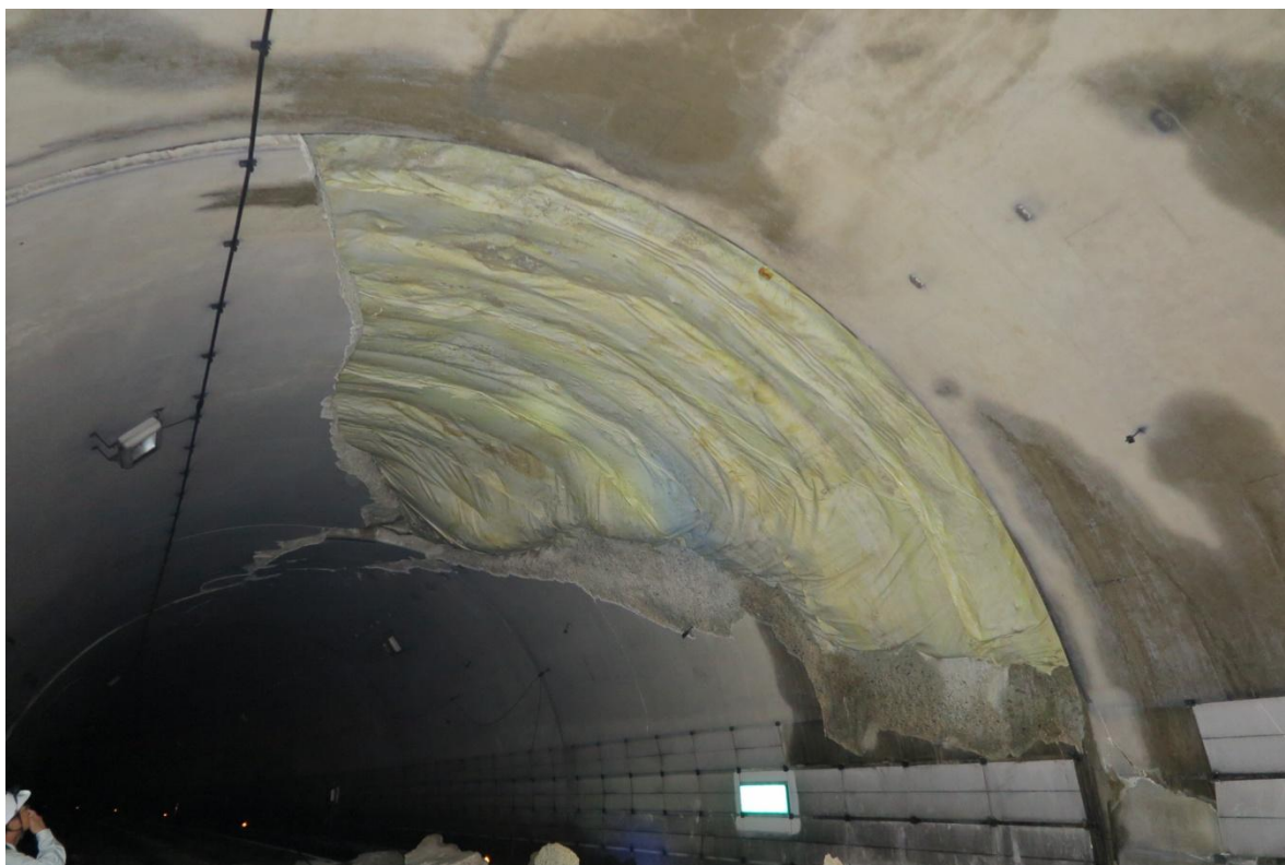
覆工コンクリートが崩落、防水シートが露出。
