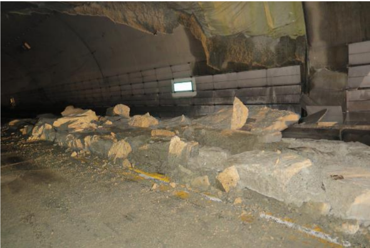
舗装版が圧縮によって浮上がり
