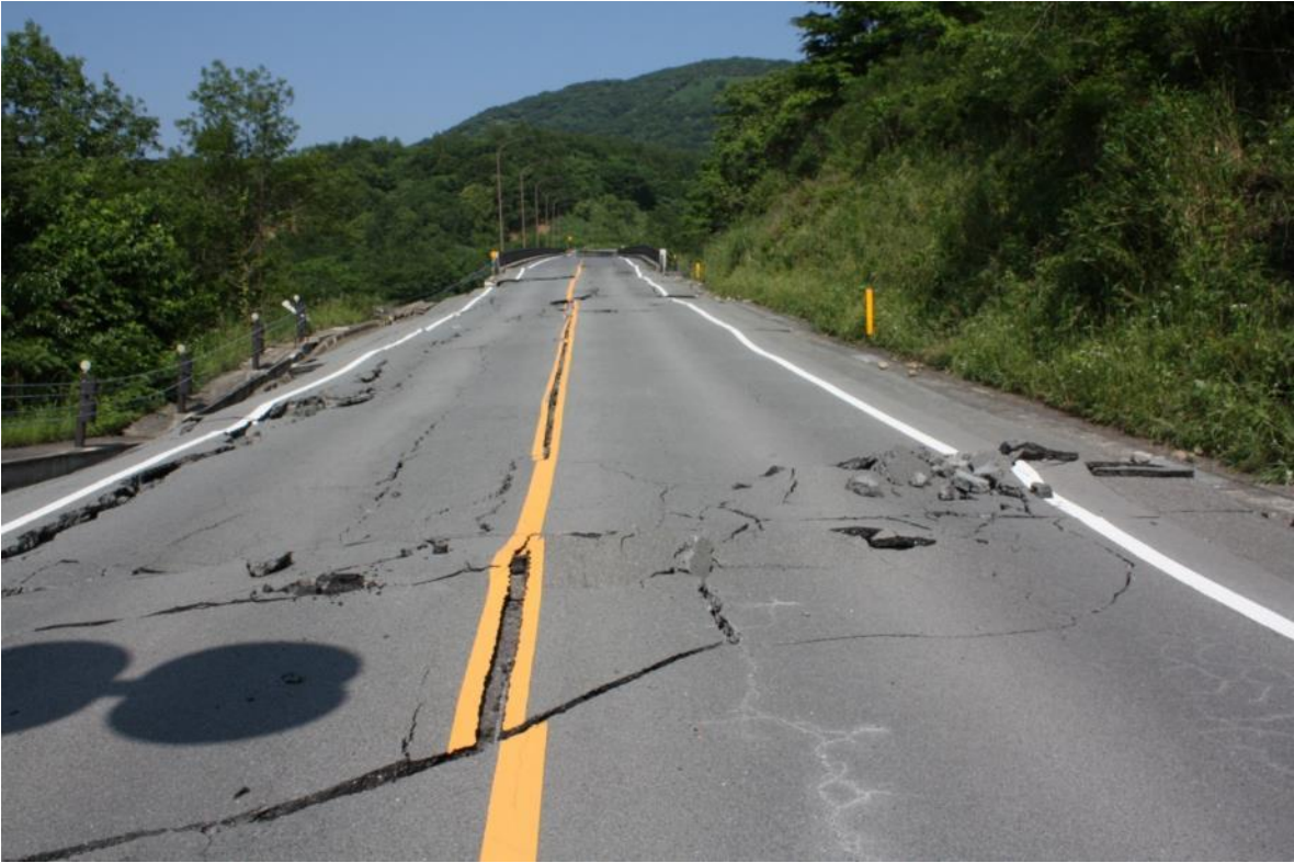
俵山トンネル出口付近（熊本側）の道路（地割れが発生）
