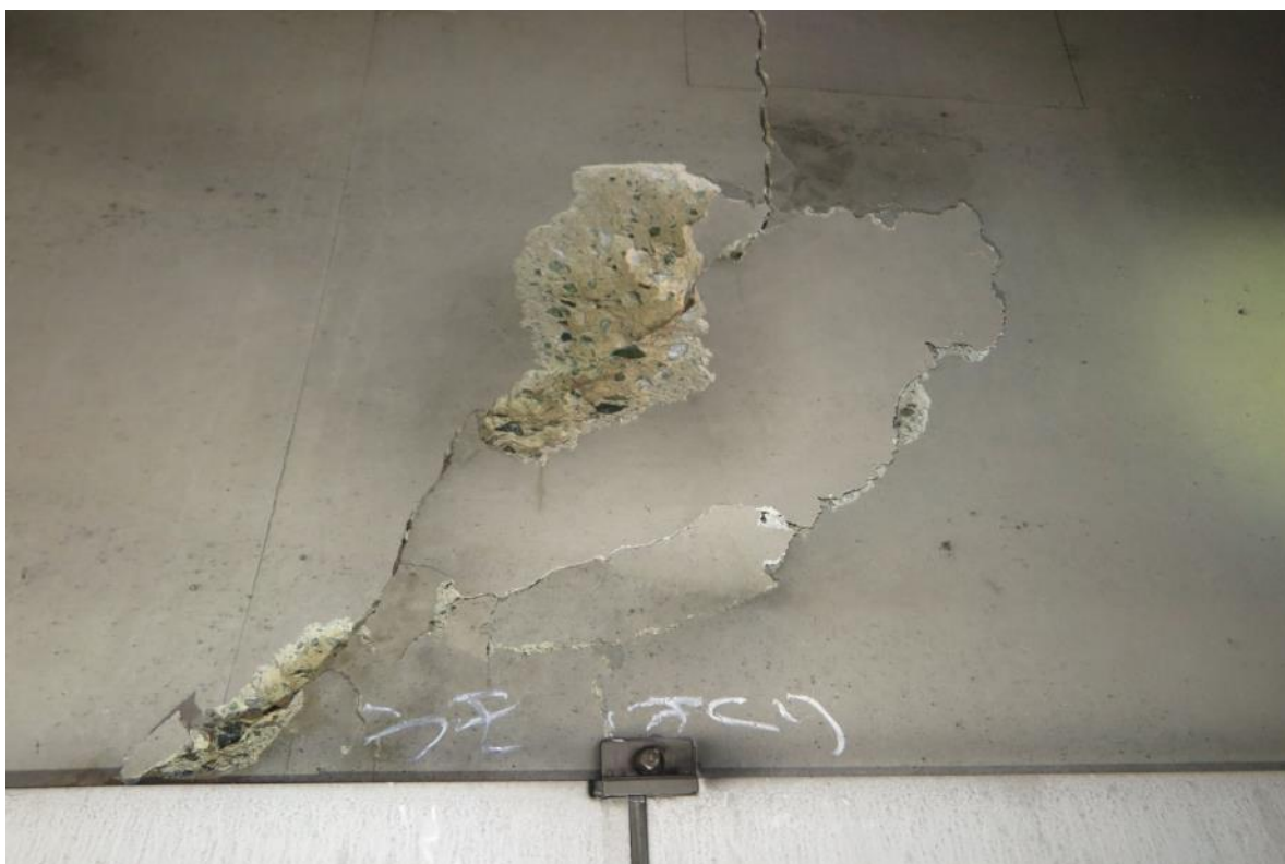
クラック交差部のコンクリート破片の崩壊
