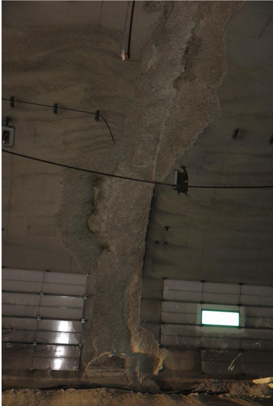
盤膨れ部の側壁部（つなぎ目が剥落）
