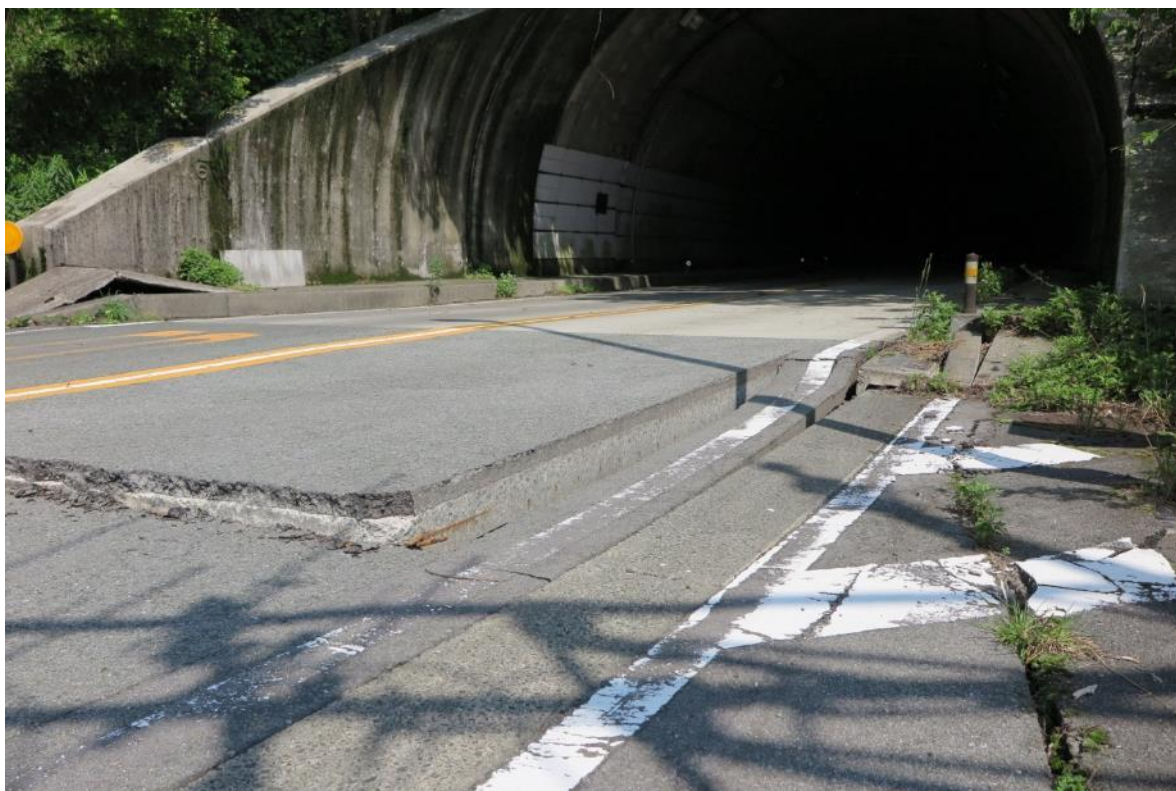
熊本側出口の路盤の段差（8 cmもある）
