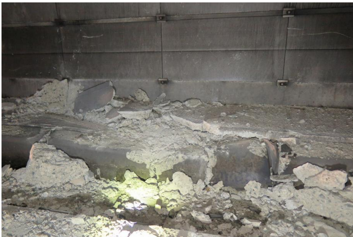
軸方向の圧縮破壊（浮上がり、せん断クラックが見える）
