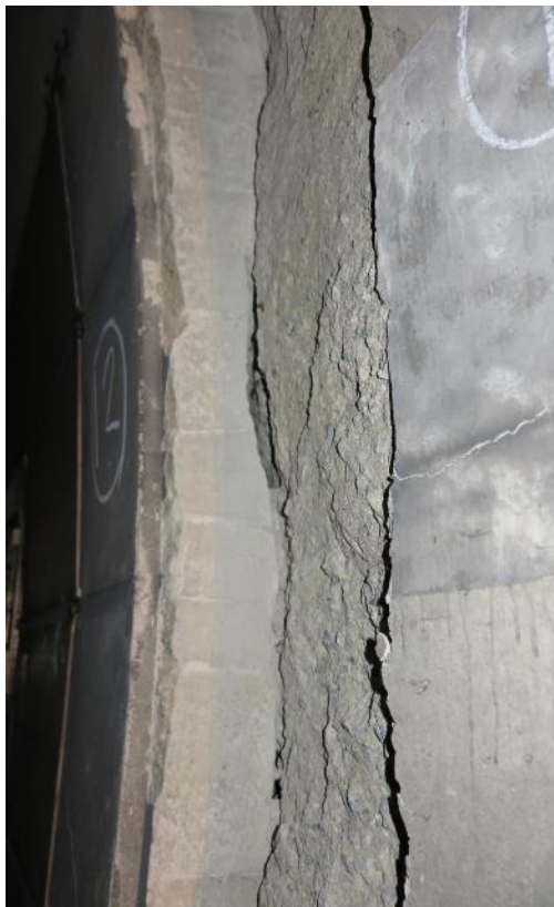
繋ぎ目のずれとコンクリート剥離
