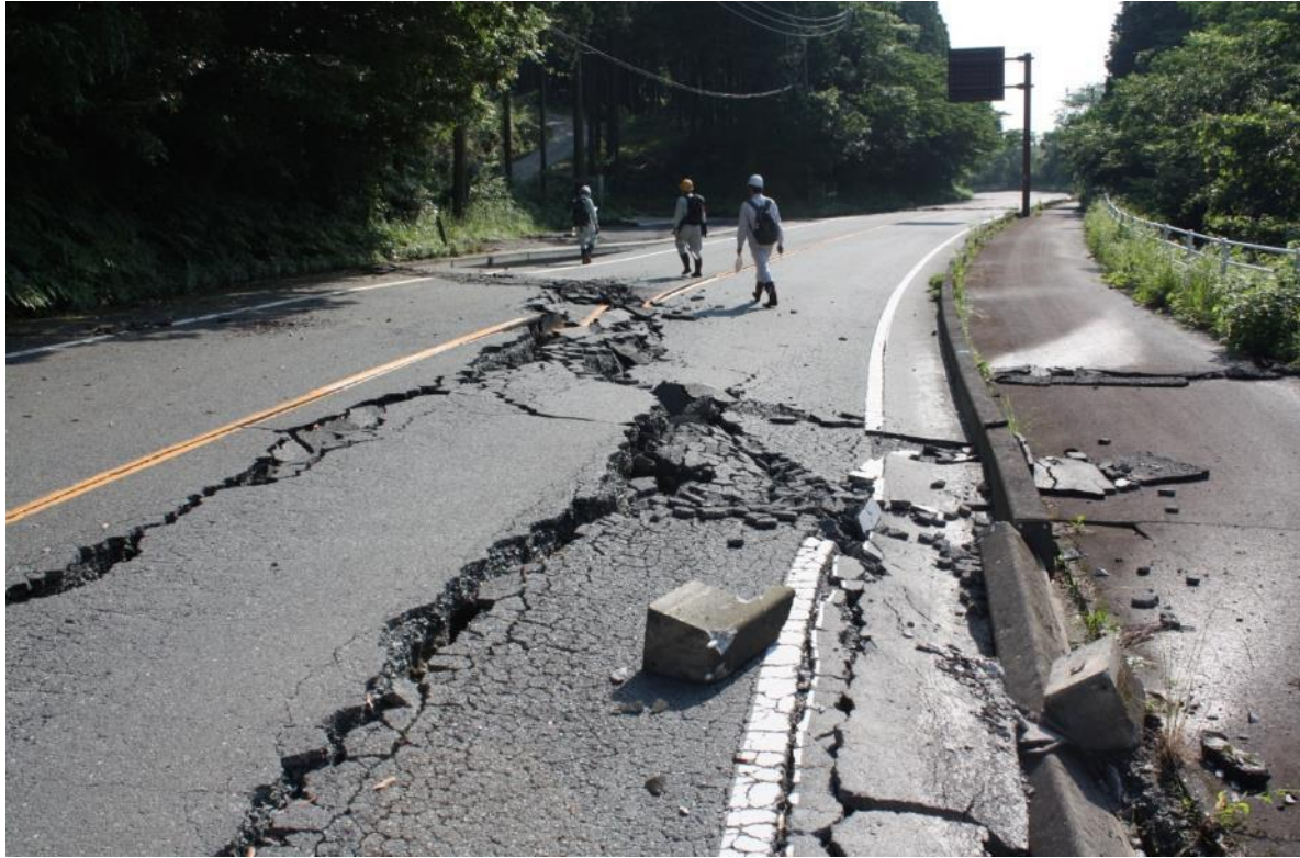
右ずれ断層付近
