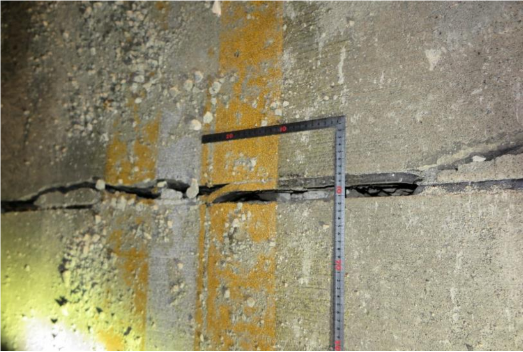
繋ぎ目の変状
