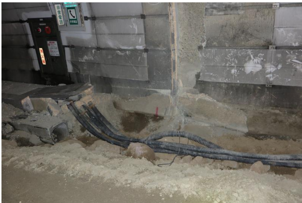
盤膨れ部の側壁部（インバートが破壊）
