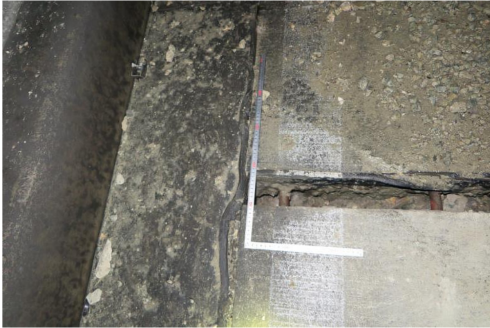
舗装版が開口
