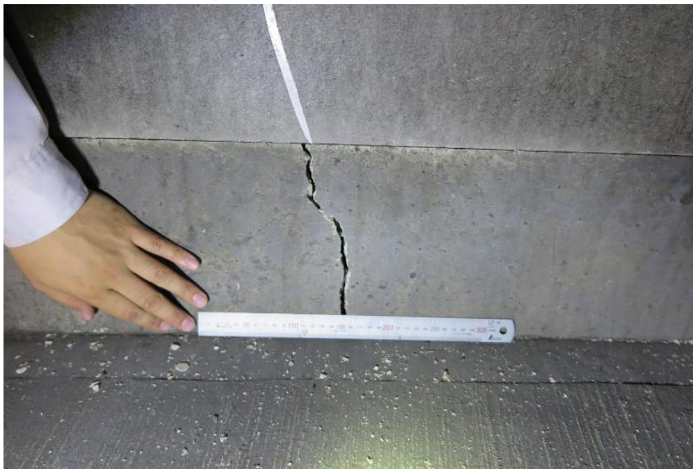
側壁部コンクリート表面には8 mm程度の開口クラック
