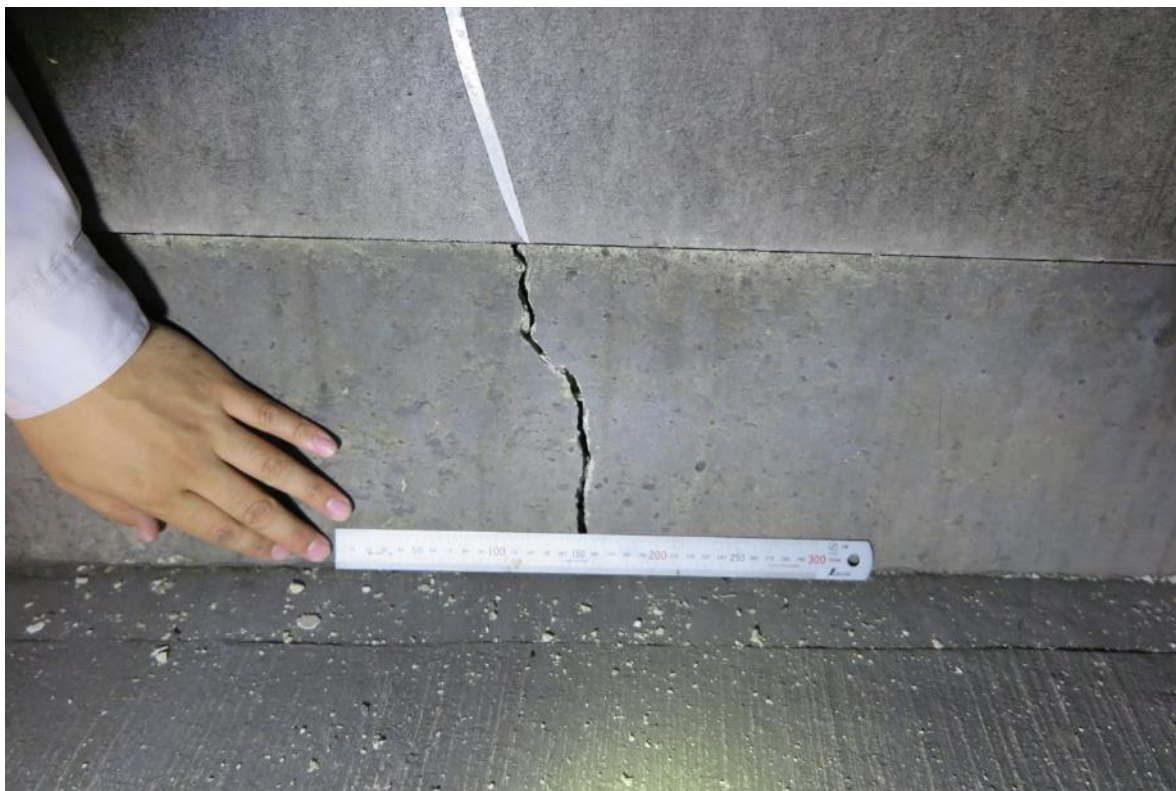
引っ張りによる開口クラック
