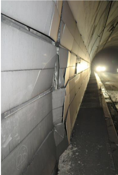
繋ぎ目のずれとコンクリート剥離
