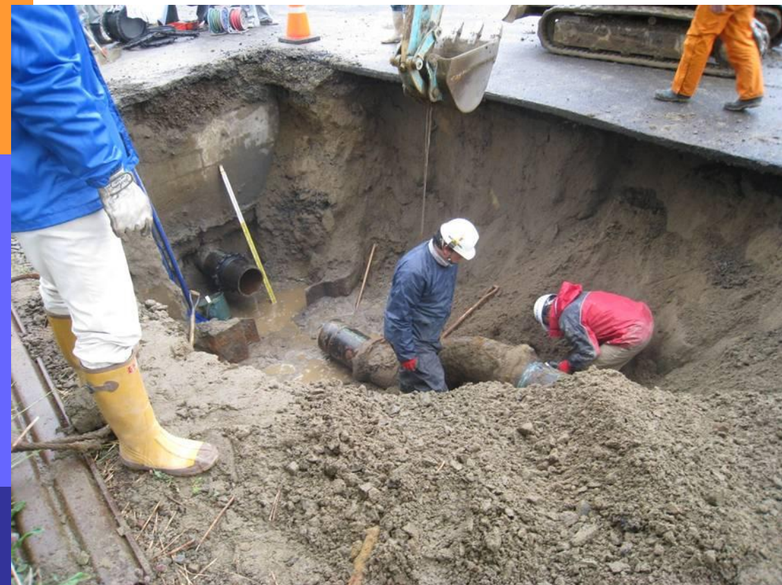
コンクリート固定部と異形管との間の管体被害 (名取市配水管DIPφ300)
