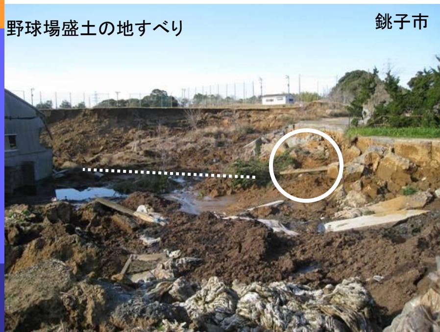
地滑りによる管路(DIPφ150)流出の被害
