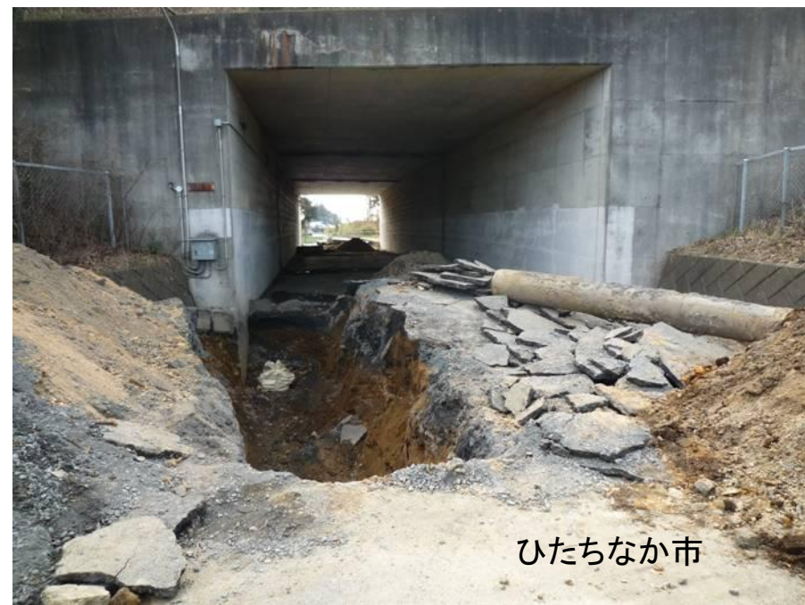
高速道路下のボックスカルバート周辺の地盤隆起による管路(DIP(A)φ350)被害
