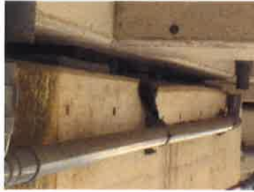
析ズレ(支承部損傷) (新玉名～熊本間)
