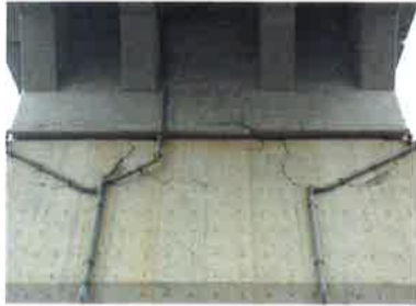
橋脚の亀裂 (熊本～新八代間)
