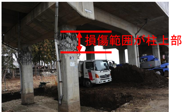
2011年東北地方太平洋沖地震による 東北新幹線の被害
