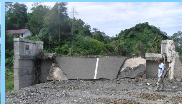
下部工の損傷
