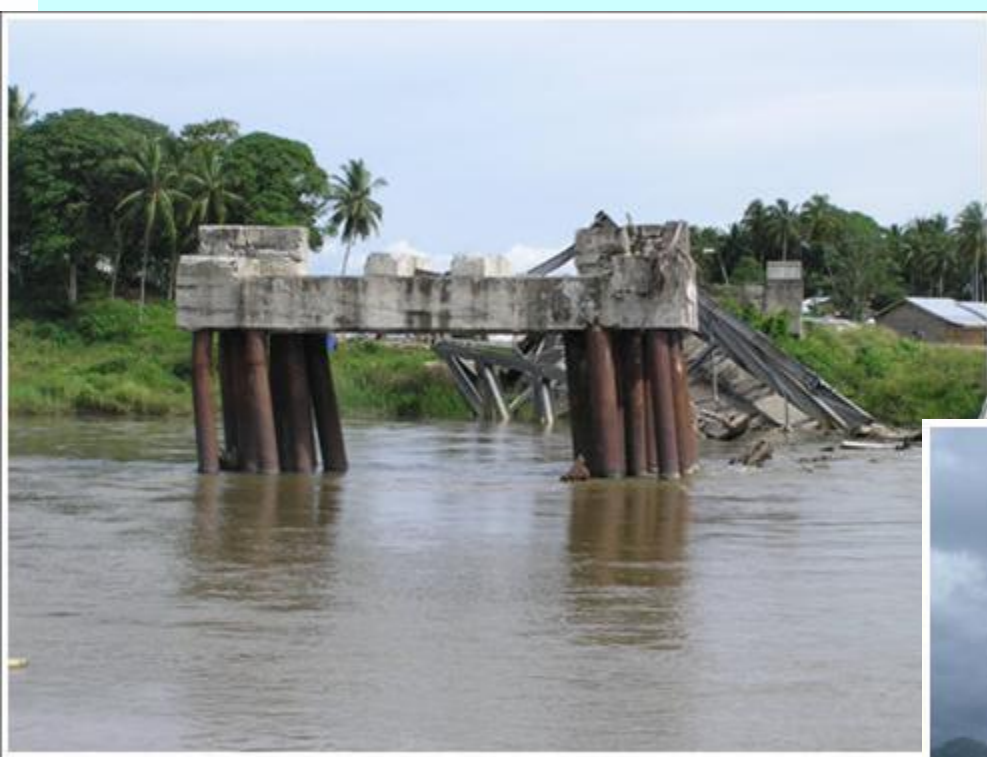
盛土の洗掘例
