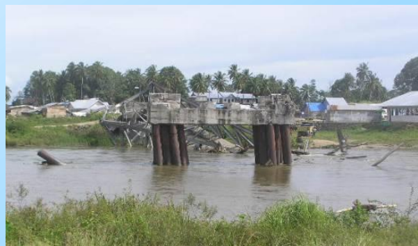
基礎部の洗掘
