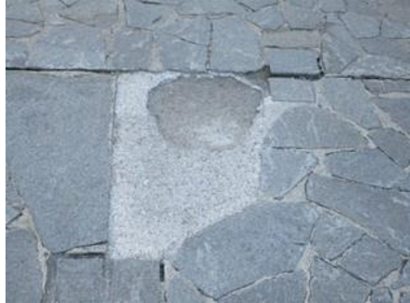
(3)ブロックの剥離
