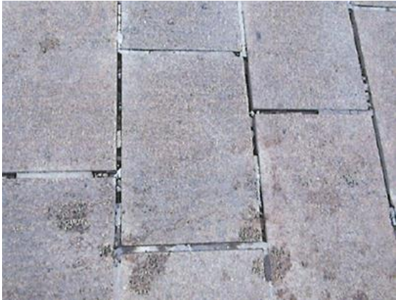
(1)目地モルタルの破損
