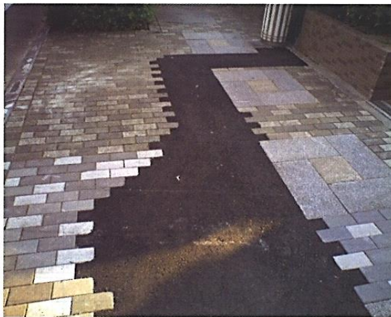
写真 7.3 景観が損なわれている例1
