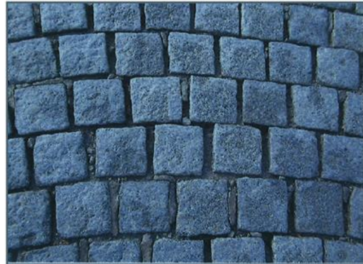
写真-3.15 目地モルタルの消失
