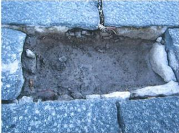
(2)敷モルタルの破損
