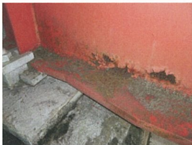
腐食 鶴間1号橋
