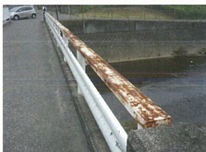
腐食 ひのき橋
