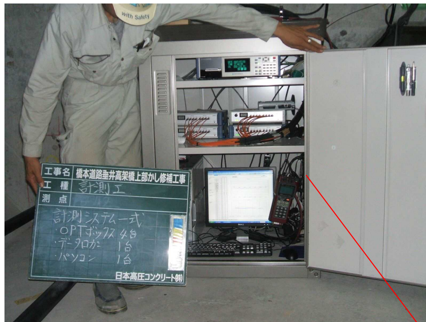
↑ 機器収納箱内の様子
