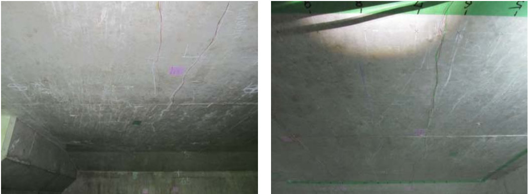
図-3. 30 上床版状況 (P6-A2)
