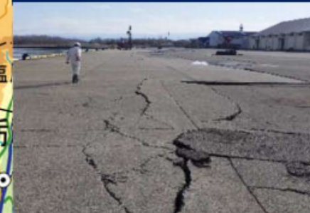
ふ頭用地の亀裂
