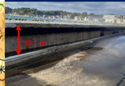
岸壁背後の沈下
