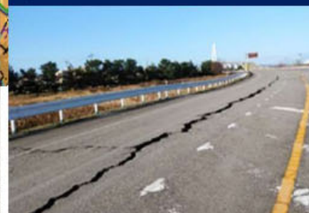
臨港道路の亀裂
