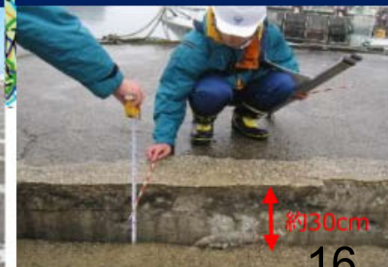
岸壁背後の沈下
