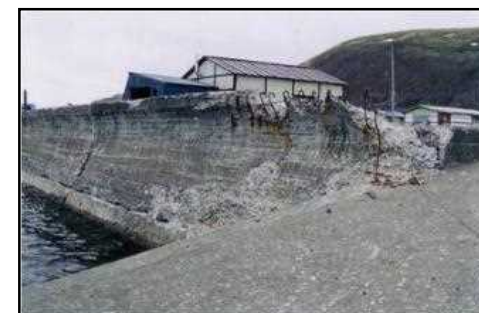
老朽化した海岸堤防
