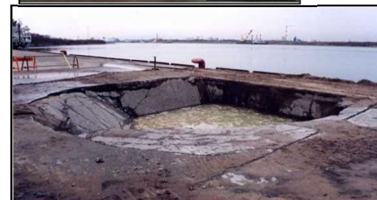
港湾施設エプロン部分の陥没
