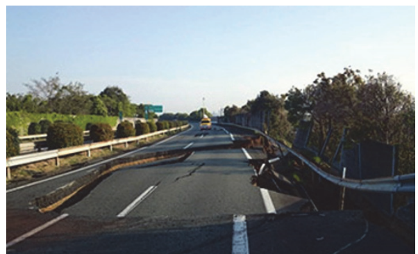
図-1 熊本地震における道路盛土の被害
