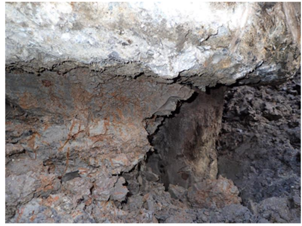
写真-3 埋め戻された粘性土に発生した褐色の筋 (I-F2 の No.3 と No.10 の木杭間)
