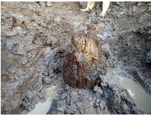
写真-2 フーチング撤去時に頭部が取れた 木杭の断面状況 (I-F2 の No.10)
