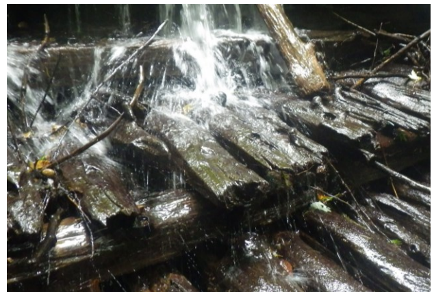
写真-10 木堰堤の部材表層部劣化状況
