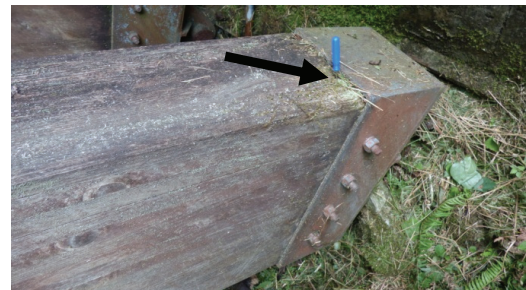
写真-3 アーチ部材端部の腐朽
