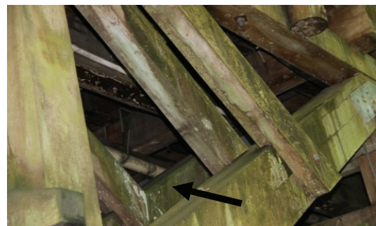
写真-6 方杖や支柱等の腐朽
