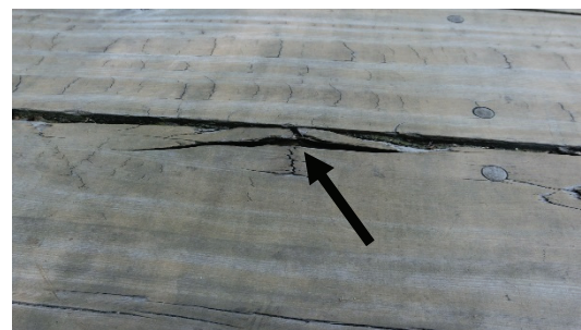
写真-5 床板の割れ
