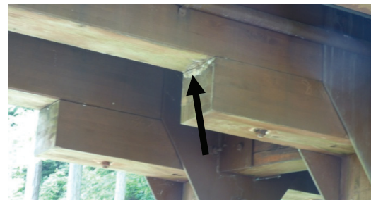
写真-4 アーチ部材支柱の補剛材の腐朽
