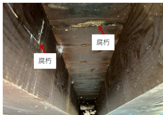
図-19 2号の桁部の劣化状態（視診）
