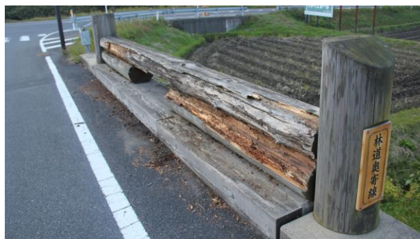
写真-9 駒止材の腐朽（2015 年）
