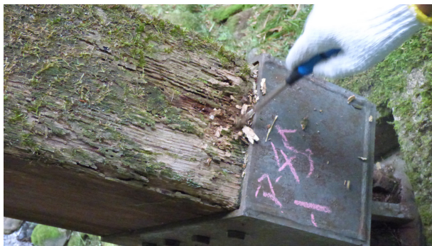
図-3 アーチ端部の腐朽
