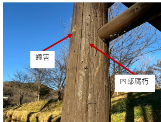
図-18 1号の橋脚部の劣化状態（視診）
