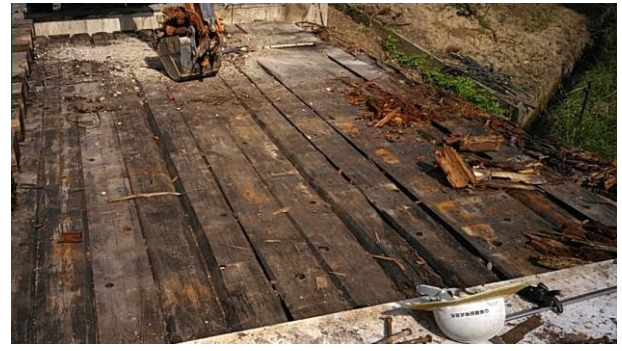
写真-14 主桁材上面の様子（2024 年）
