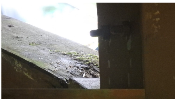
図-2 縦桁とアーチの接合部の腐朽
