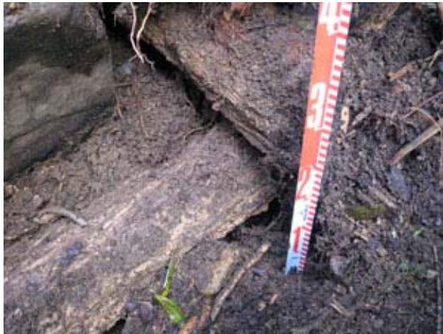
写真-6.1.4.1 腐朽状況
