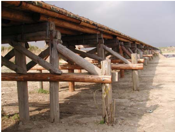
写真-2.2.7 部材交換により維持管理がなされている木橋（上津屋橋／京都府）
