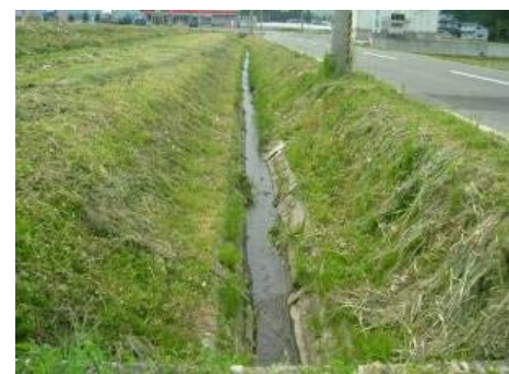
(b) 水路脇の腐朽している木杭
