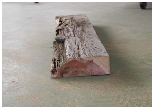
写真-4 辺材のみが腐朽したスギ床版
