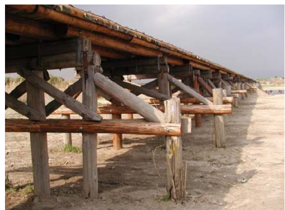
写真－2 大規模補修後部材が転用されている例（上津屋橋・京都府）
