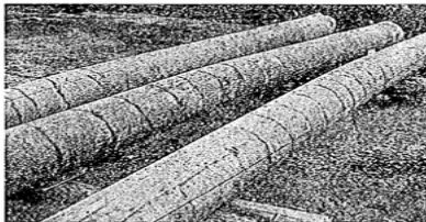
写真-3.4.7 可動橋換脚のRCぐいの変状（その2）
