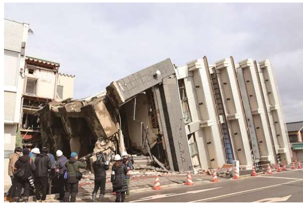
写真4 輪島市河井町 被災市街地 (上：広域火災の現場、下：ビル倒壊の状況)
