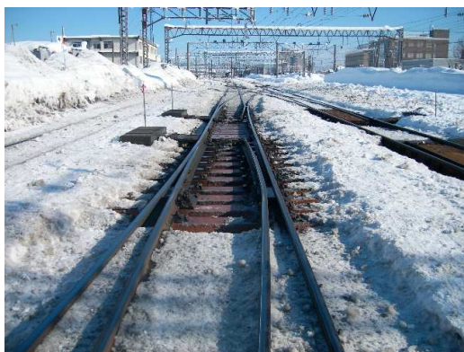
分岐器融雪ピット（函館線岩見沢駅構内）
