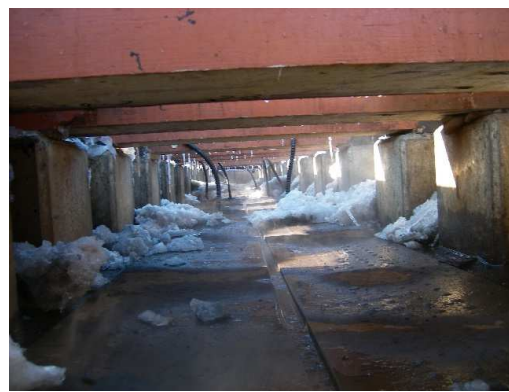
分岐器融雪ピット内部
