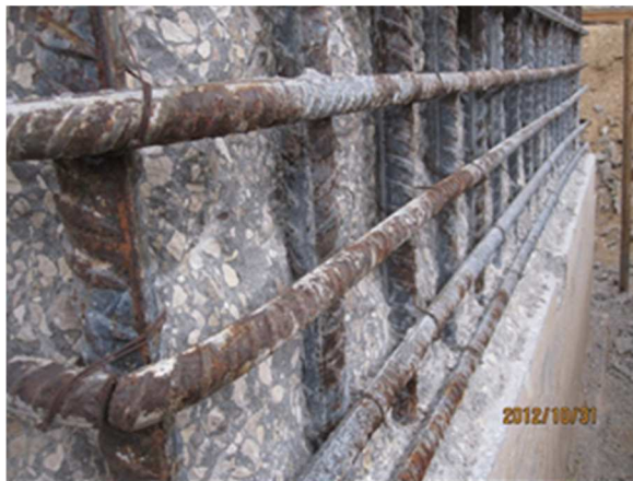
橋脚の錆発生状況
