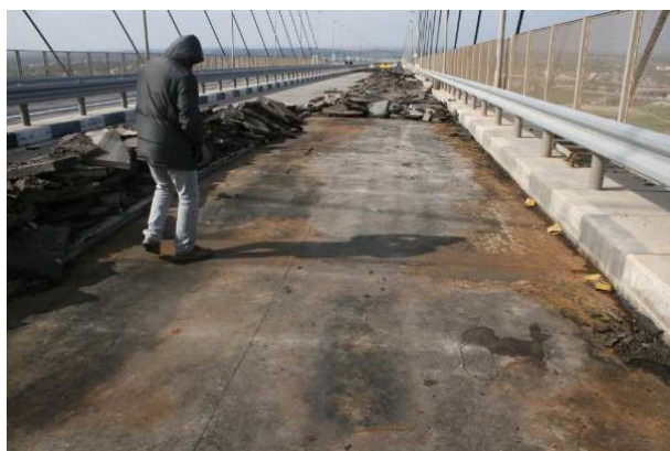
鋼床版表面の錆発生状況（その2）
