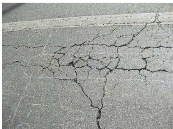
舗装クラック
