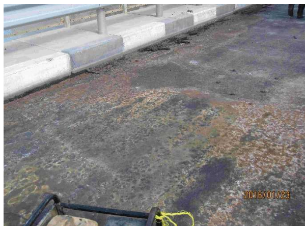
鋼床版表面の錆発生状況（その1）
