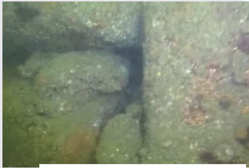
コンクリートブロック損傷状況（水中部）
