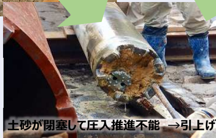
杭頭部 の偏り による 排出不良
