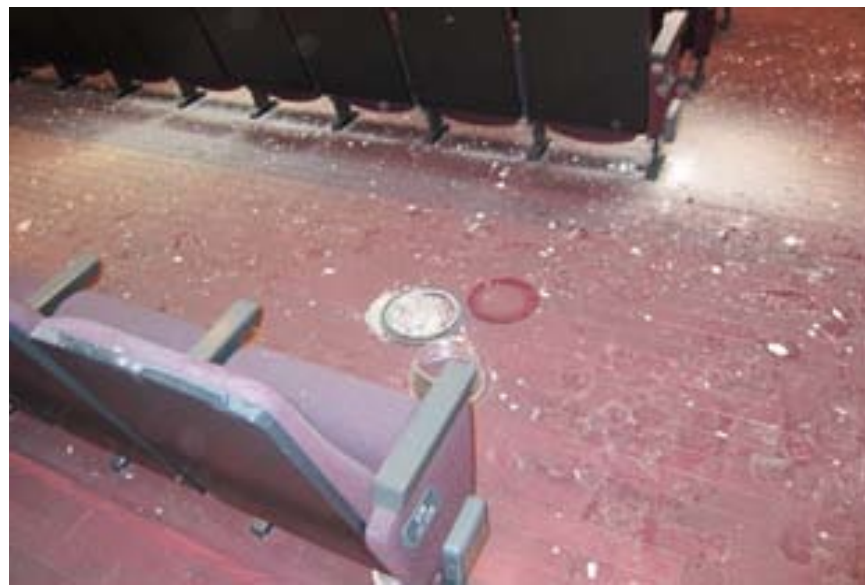
照明器具の落下
