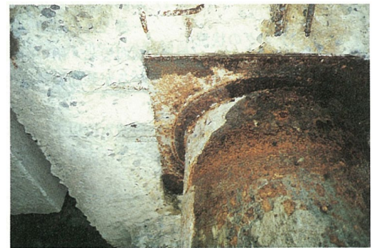
写真 5 兵庫県南部地震の建築基礎の杭頭のずれ
