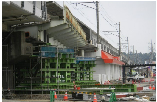
写真7 東北地方太平洋沖地震の鹿島線架道橋の桁ずれ
