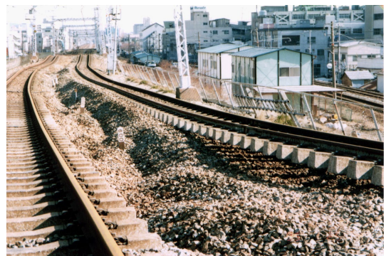
写真 6 兵庫県南部地震の JR 神戸線盛土の崩壊
