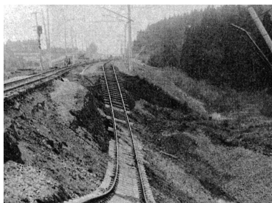
写真3 十勝沖地震の東北本線盛土の崩壊
