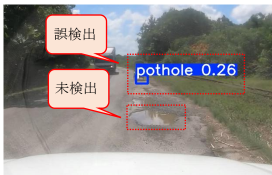
図 2 舗装損傷の検出結果（最適化前）
