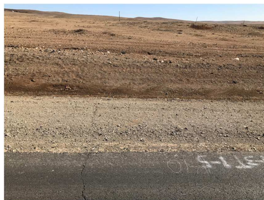
図 2 低温ひびわれ状況
