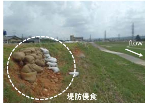
図-6 3.4km 外岸における堤防表法面侵食 2)
