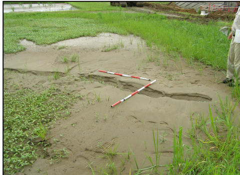
写真③ 堤内地法尻近くの噴砂跡
