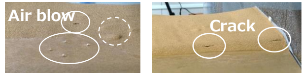
図- 4 水位上昇時に堤防天端で発生したエアブローと法肩の亀裂発生の様子
