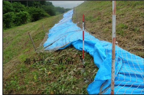
写真⑤ 堤体法面の縦断方向クラック
