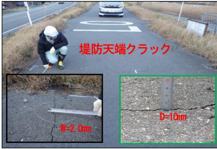
写真⑦ 堤防天端舗装の横断クラック
