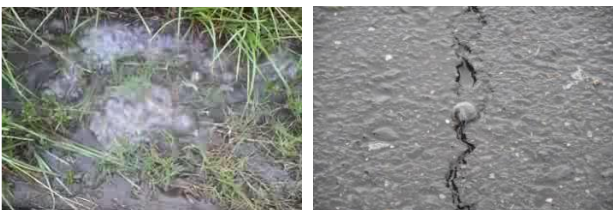
(a)庄内川右岸 (2011.9) (b)鬼怒川右岸 (2015.9) 2) 図- 1 実堤防で見られたエアブロー現象
