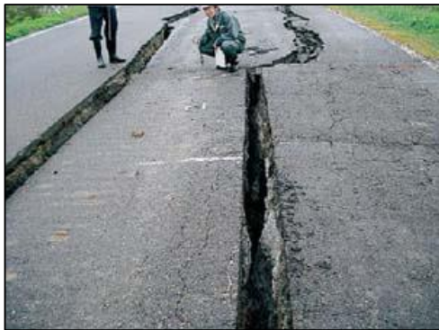
写真① 堤防天端の道路に発生した亀裂の状況
