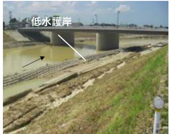
図-1 平成 23 年 7 月新潟・福島豪雨時の高水敷・低水護岸洗掘被害(1.1km 右岸) 2)
