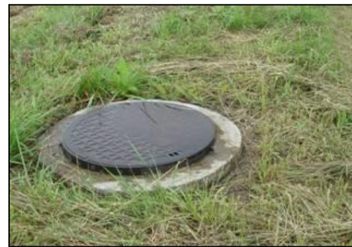
写真⑥ 堤防天端マンホールの浮き上がり
