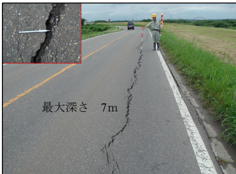
写真④ 堤防天端道路の縦断クラック
